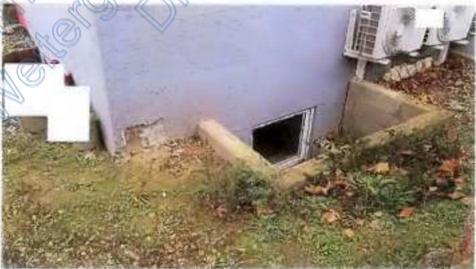
Hausecke mit Schadstellen / oberer Rand Kellerlichtschacht ohne Abdeckung
