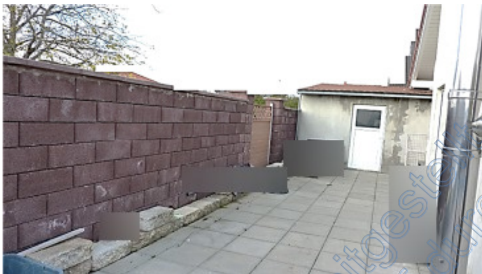
hinterer Hof und Lagergebäude mit Feuchteschäden
