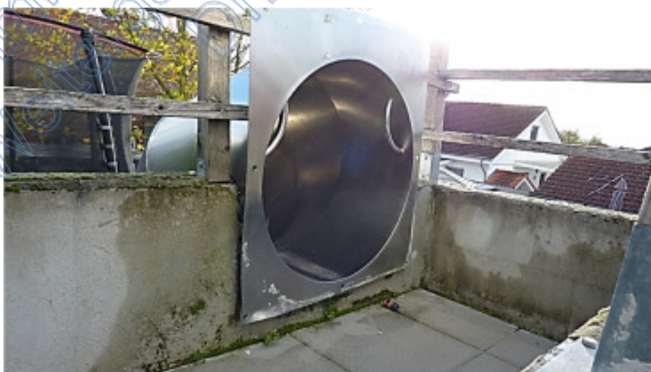
Feuchteschäden Treppenturm und fehlende Geländer im oberen Bereich / Mauerabdeckungen fehlen
