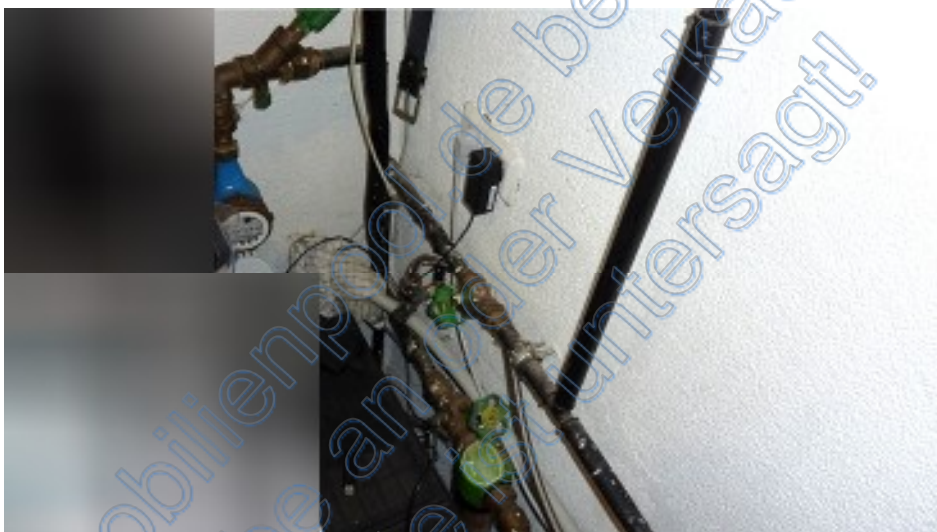
Technikanschlüsse im Abstellraum
