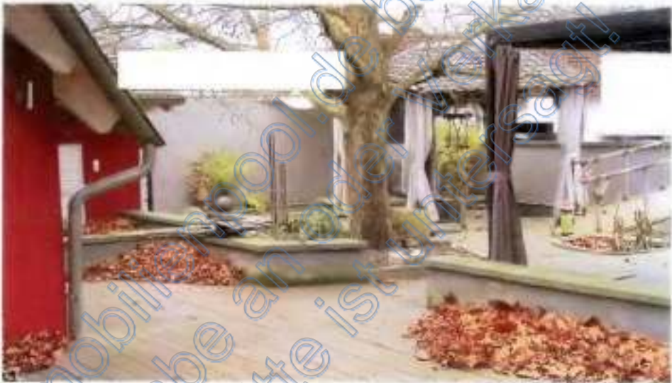
Pavillon / Sitzplatz / Mauerchen mit erheb. Putz-, Feuchteschäden im Sockelbereich
