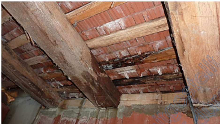
Lagergebäude mit Feuchteschäden im Dachbereich
