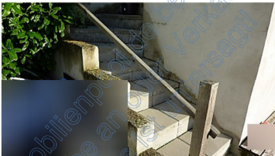
Feuchteschäden Treppenturm und fehlende Geländer
