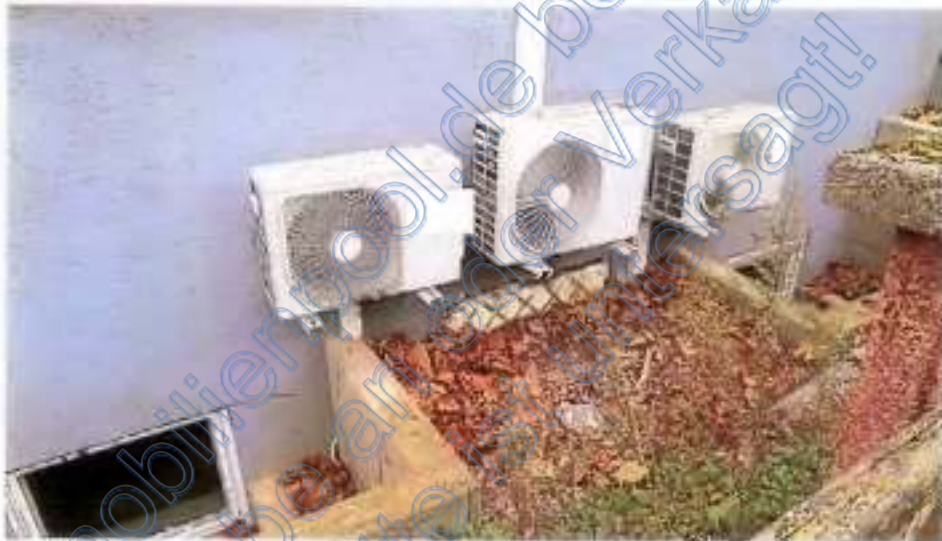
Außenklimageräte an der Fassade
