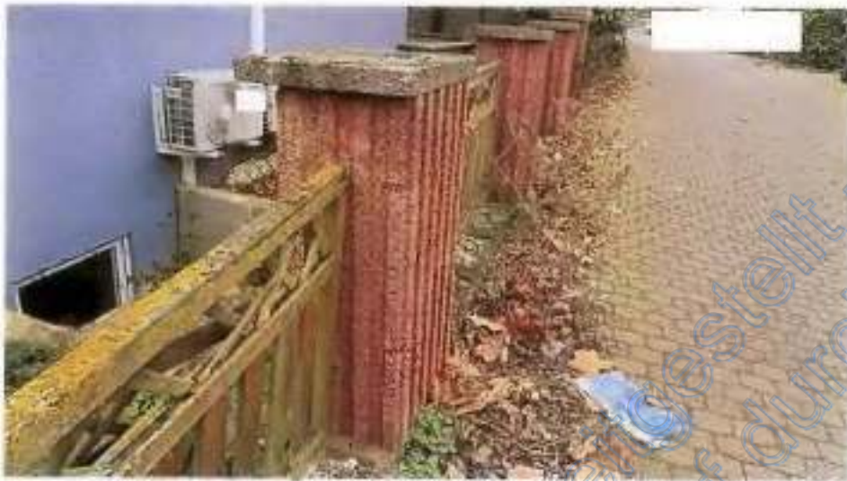
unregelmäßige leicht schiefe Mauerpfiler
