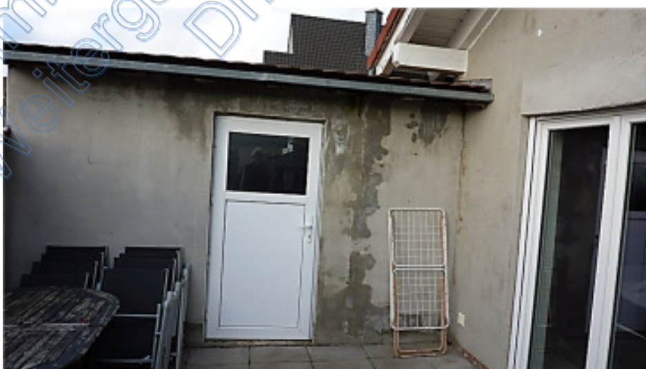
Lagergebäude mit Feuchteschäden
