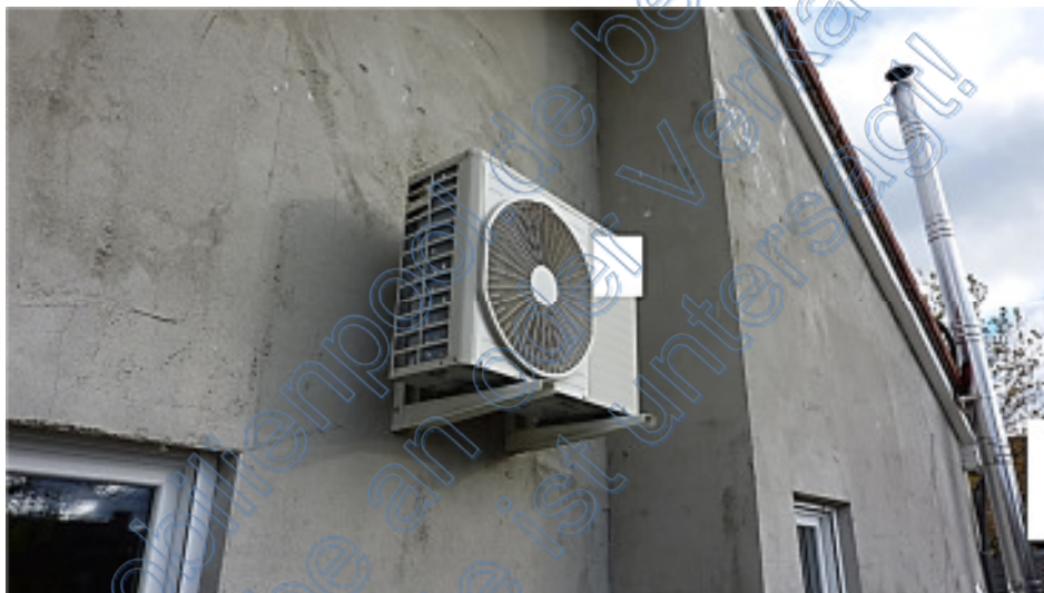
Außenwandgerät für Klimagerät im Schlafzimmer
