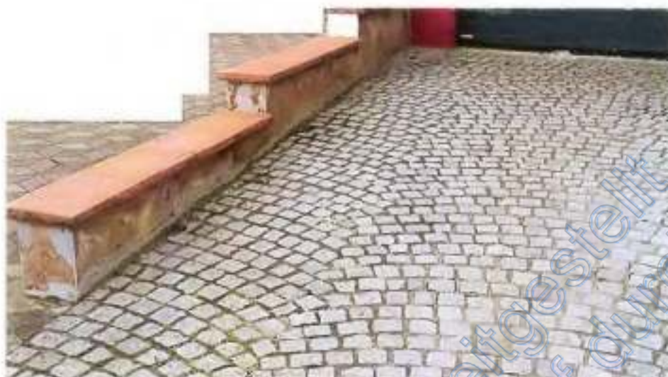
seitliches Einfriedungsmäuerchen zum Nachbargrundstück mit Putz- und Feuchteschäden
