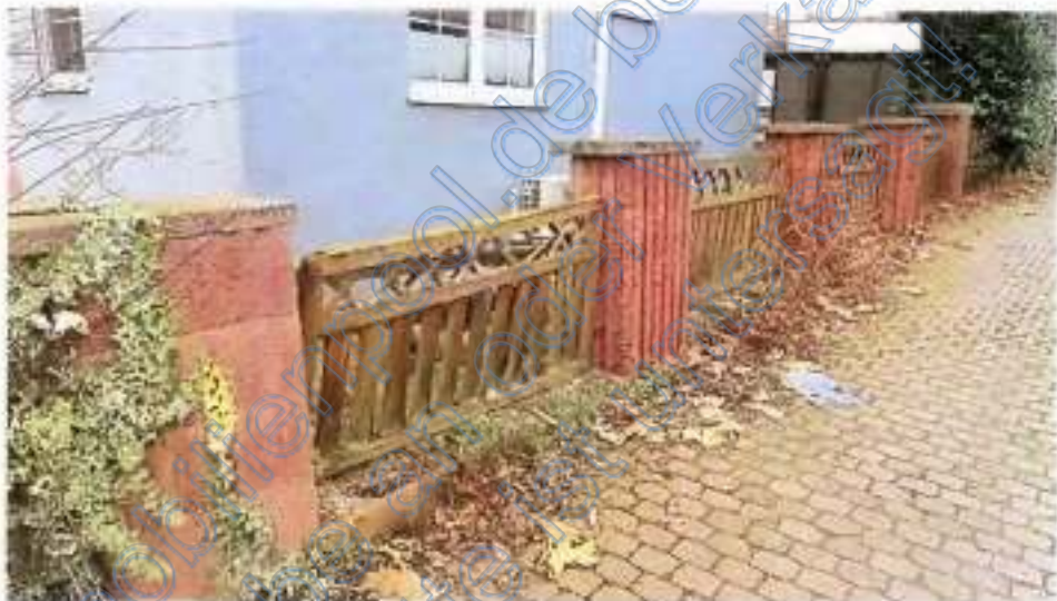
Einfriedung mit Holzzaun und Schadstellen
