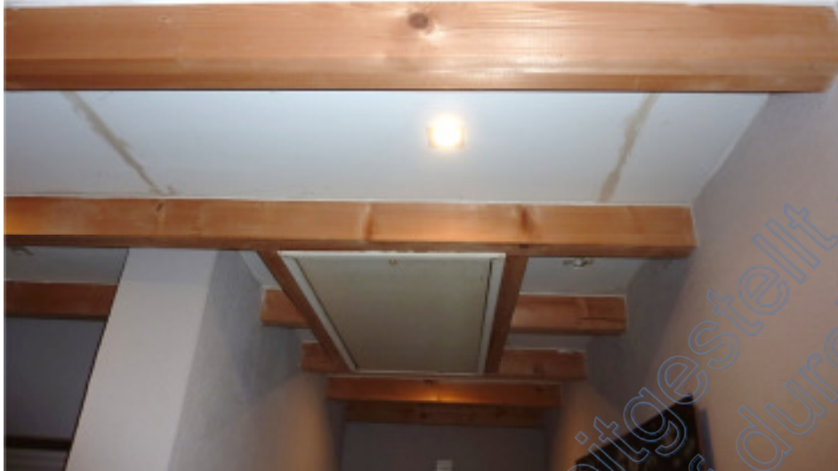
tlw. unsaubere Plattenstöße im Bereich der Gipskarton-Deckenplatten (tlw. einfach verspachtelte Fugen)
