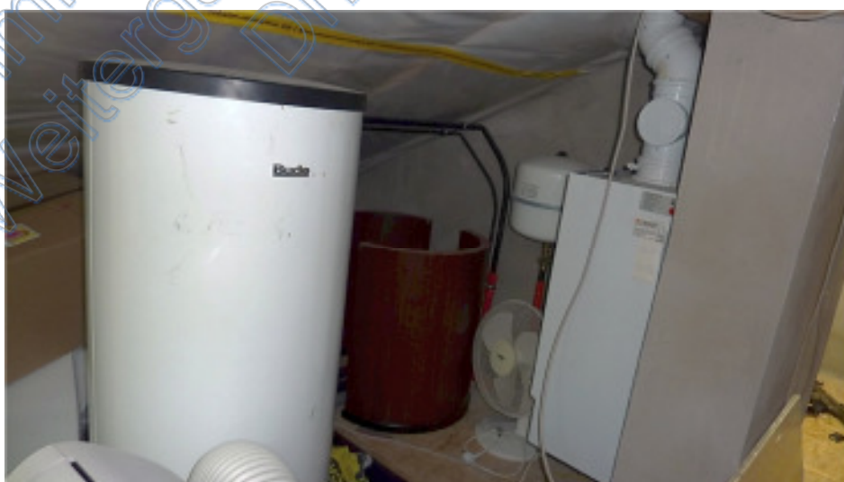
Gastherme und Warmwasserspeicher im Speicher
