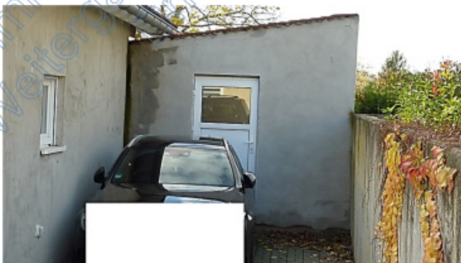
kl. Lagergebäude mit Feuchteschäden an der Fassade
