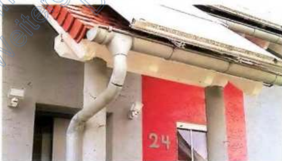
Fallrohr Vordach nachzubessern / tlw. unregelmäßiger Verputz
