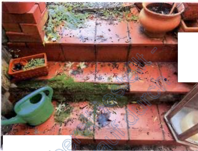
Abb. 4: Foto des SV; z.T. Außentreppenbelag schadhaft (Fliesenschäden)
