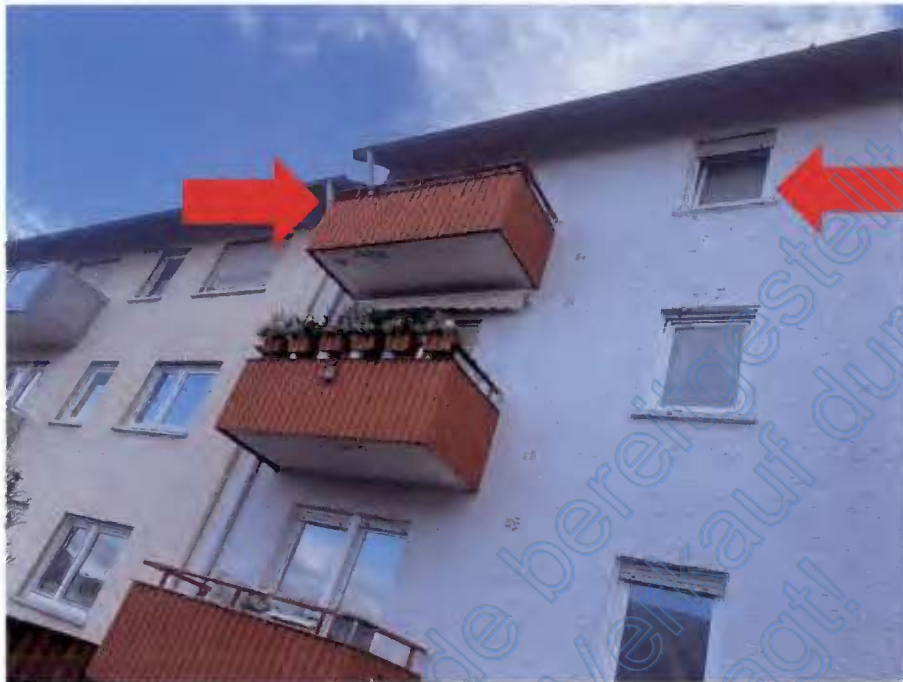
Bild 7: Blick auf Feuchtigkeitserscheinungen an den Unterseiten der Balkone
