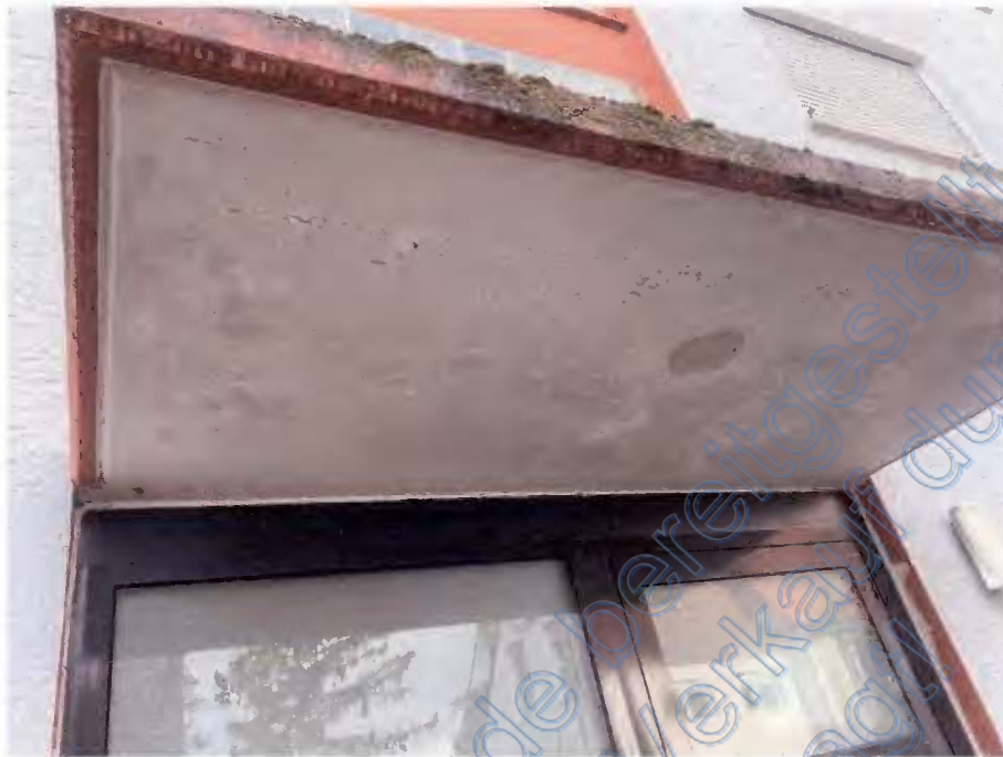
Bild 9: Blick auf Feuchtigkeitserscheinungen der Eingangsüberdachung
