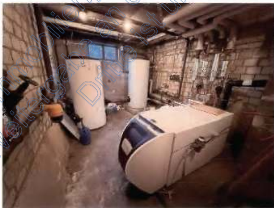
Bild 6: Blick in den Heizungsraum
