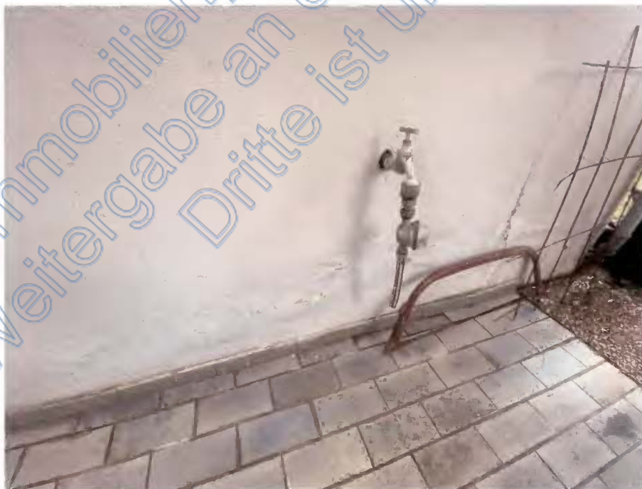
Bild 8: Blick auf Feuchtigkeitserscheinungen und Putzabplatzungen an der Außenwand
