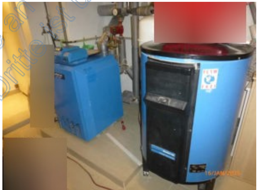
Zentralheizung im Keller
