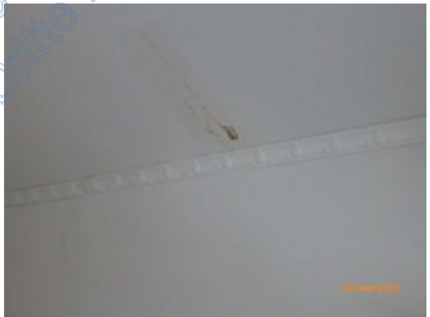
Wasserschaden im Erdgeschoss
