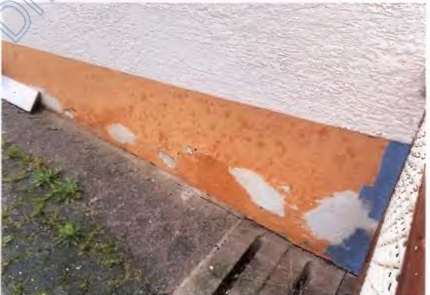
Abb. 5: Foto des SV; z.T. Sockel des Nebengebäudes mit Farbablösungen
