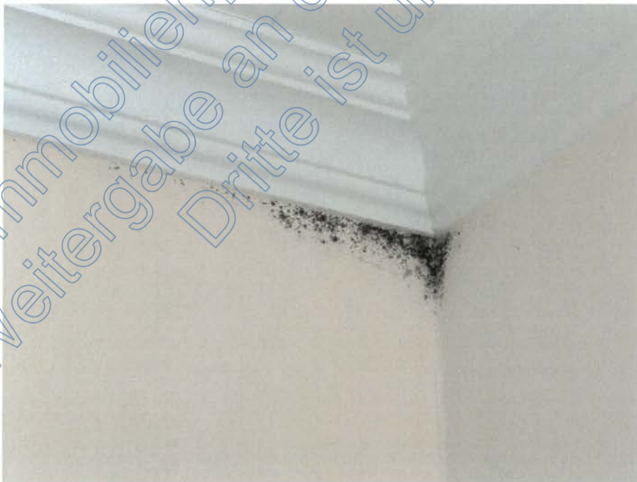
Bild 14: Blick auf einen Schimmelschaden im Schlafzimmer
