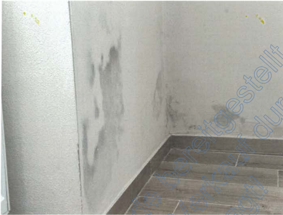
Bild 13: Blick auf einen Feuchtigkeits-/Schimmelschaden im Esszimmer
