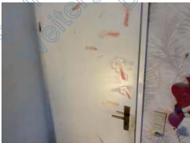
Zustand Türen (innen)
