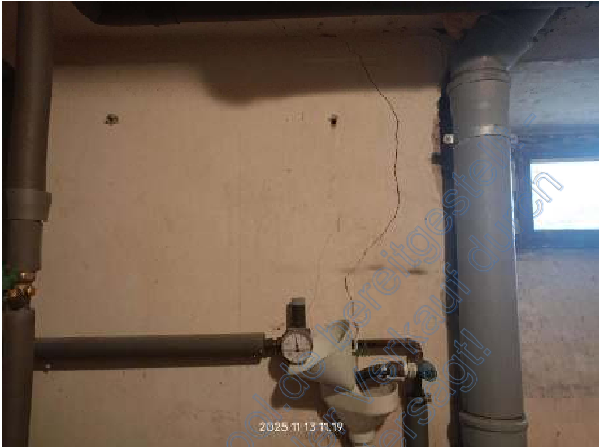
Laut Zutprotokollgabe auf dem Ortstermin teildefekte Versorgungstechnik. Risse in der Bausubstanz als exemplarische Darstellung des Unterhaltungsstaus.
