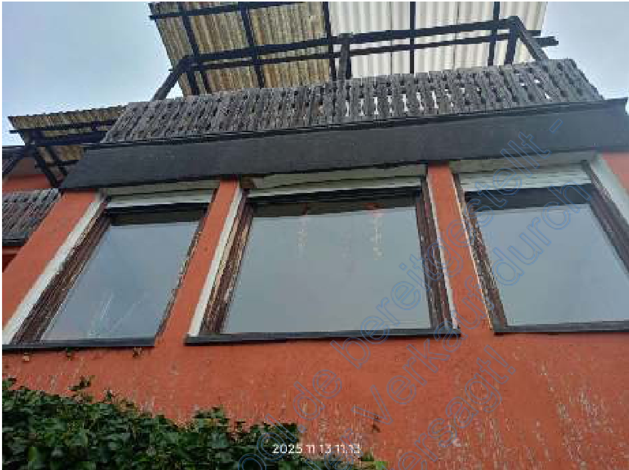
Blick auf den rückwärtigen Bereich des Wohngebäudes mit erkennbaren Verwitterungsspuren an den Außenbauteilen.
