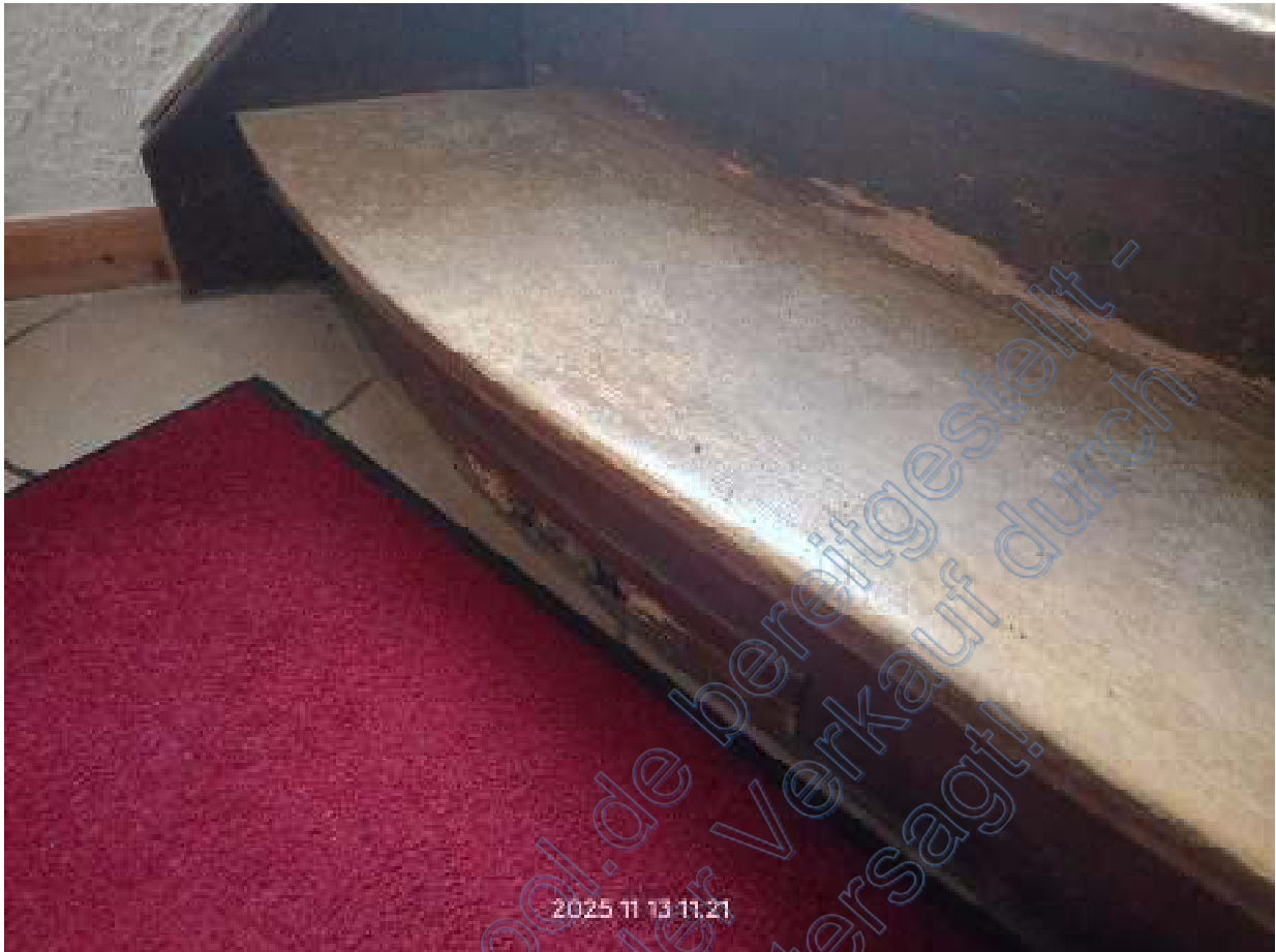
Beschädigungen und erhebliche Gebrauchsspuren an der Geschosstreppe.
