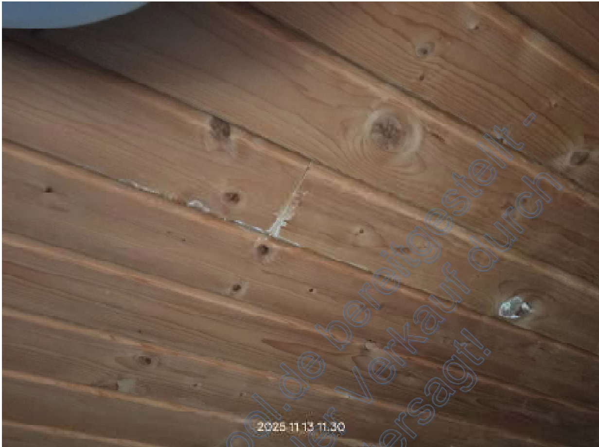
Schadhafte Stellen an der unteren Seite der Decke zwischen Dachgeschoss und Obergeschoss. Laut Zurprotokollgabe auf dem Ortstermin durch die anwesenden Mieter durch eindringendes Wasser der Dachhülle.
