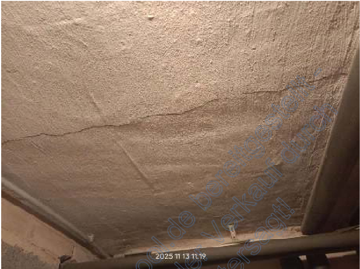
Rissbildung in der Tragsubstanz im Kellergeschoss
