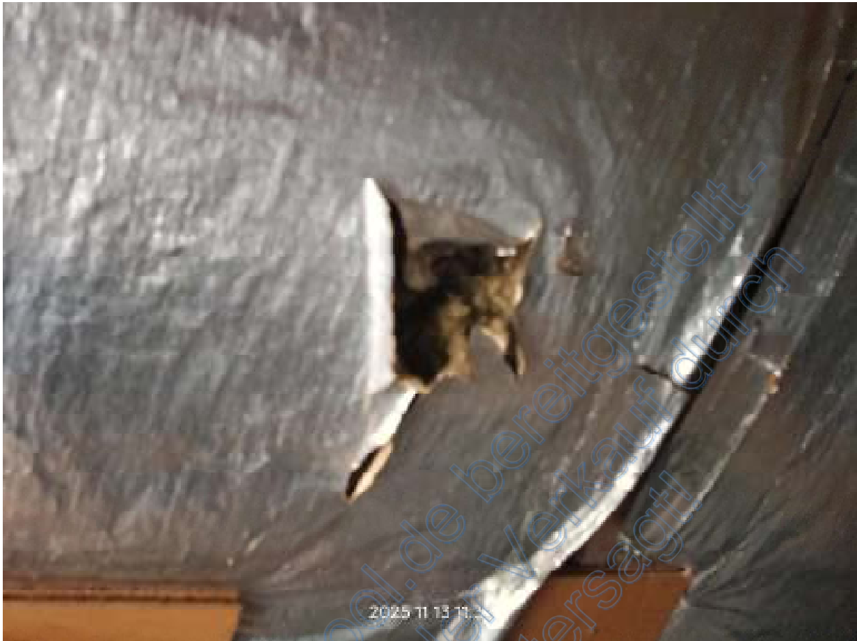
Dämmung im nichtausgebauten Bereich des Dachgeschosses mit stark beschädigter, fehlender oder nicht mehr funktionaler Metallbahn.
