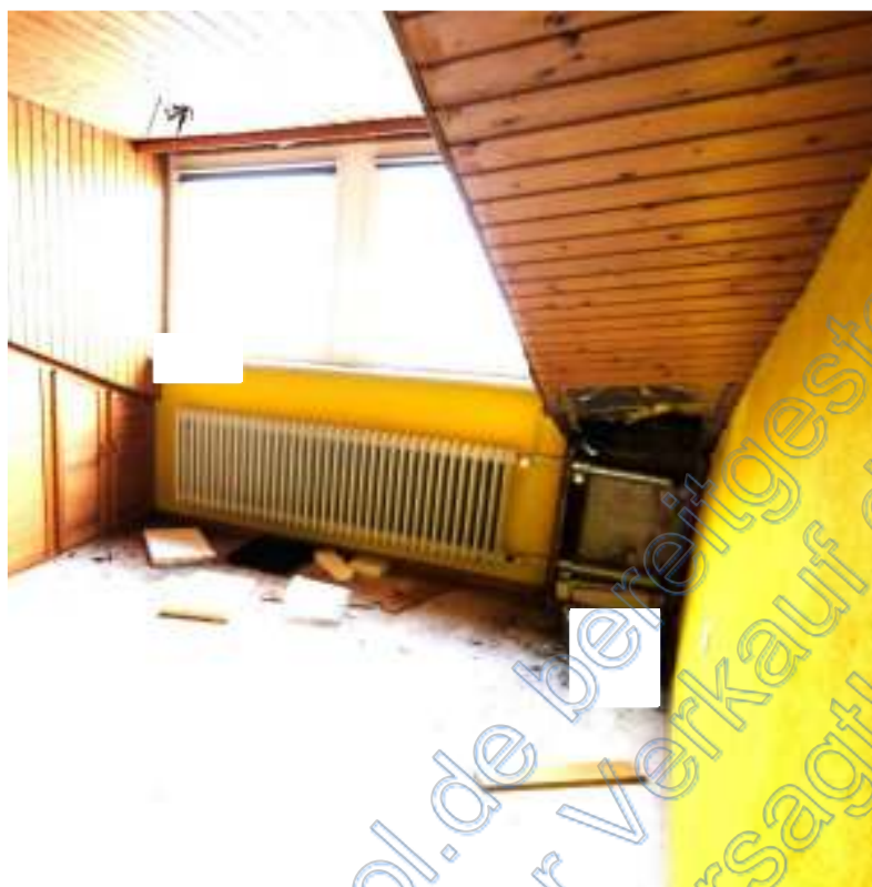
Deckenverkleidung Zimmer DG schadhaft
