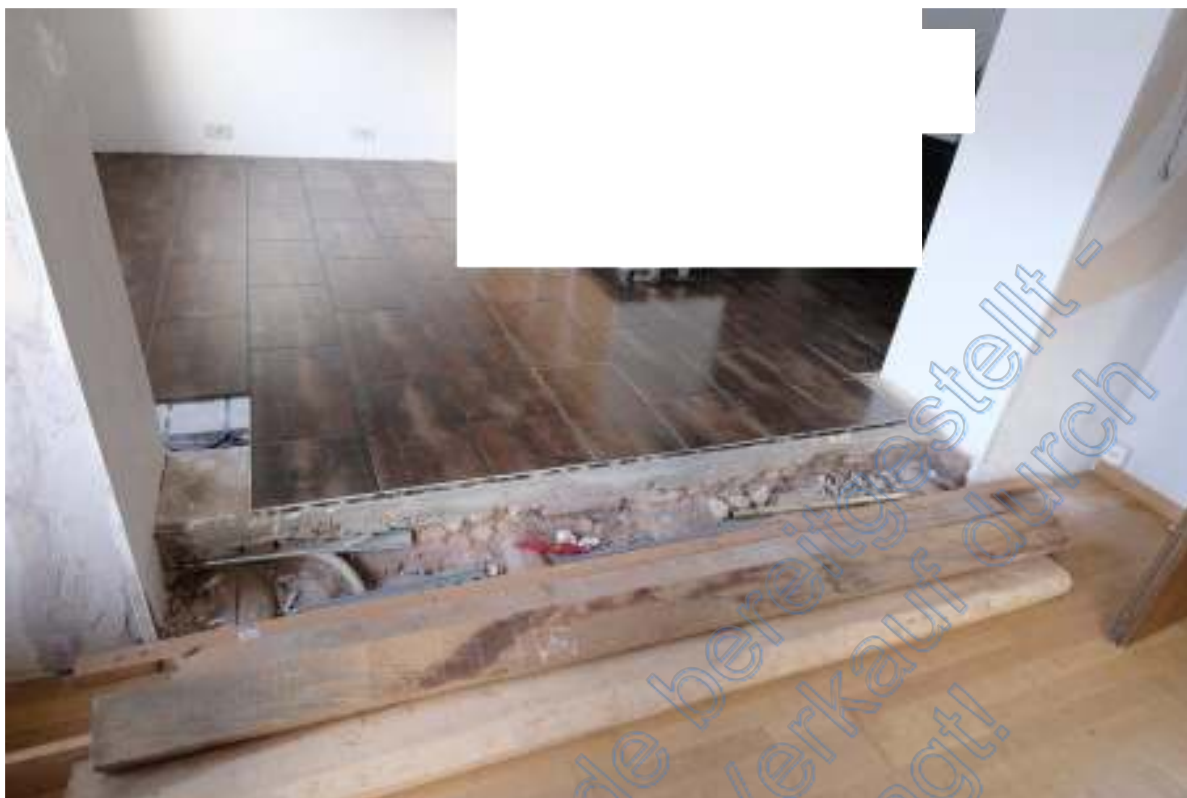
Fußboden / Stufe nicht fertiggestellt
