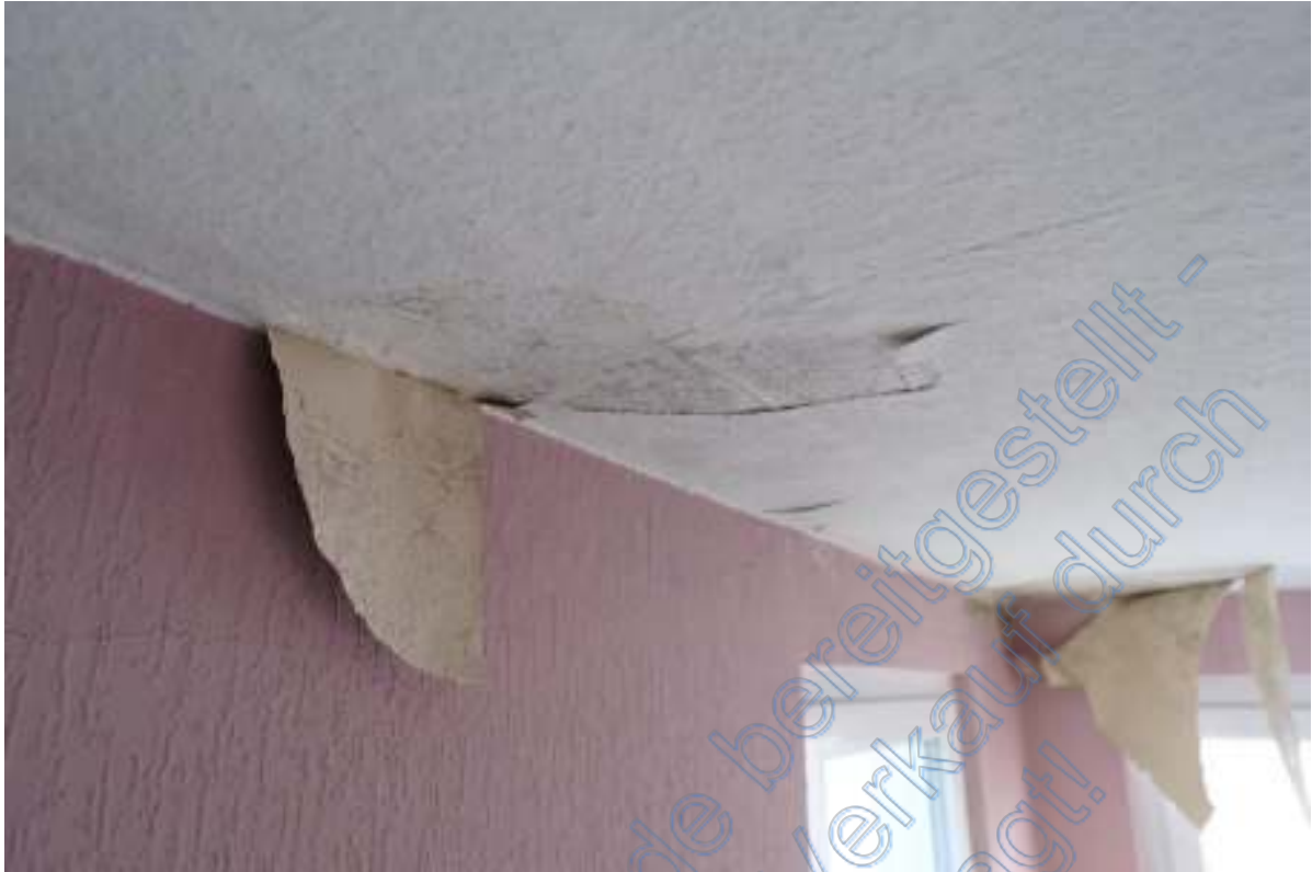
Deckenbelag Anbau abgängig
