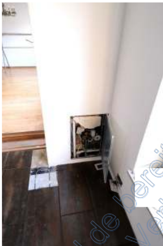
Fußbodenheizung nicht fertiggestellt
