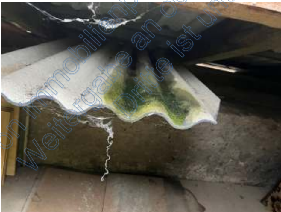
Nr. 22 Eigenkonstruktion nach Wassereintritt
