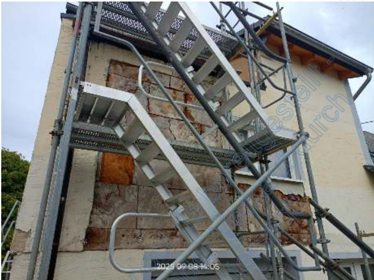
Temporäre Erschließung der DG-Wohnung mit schadhafter Fassade.
