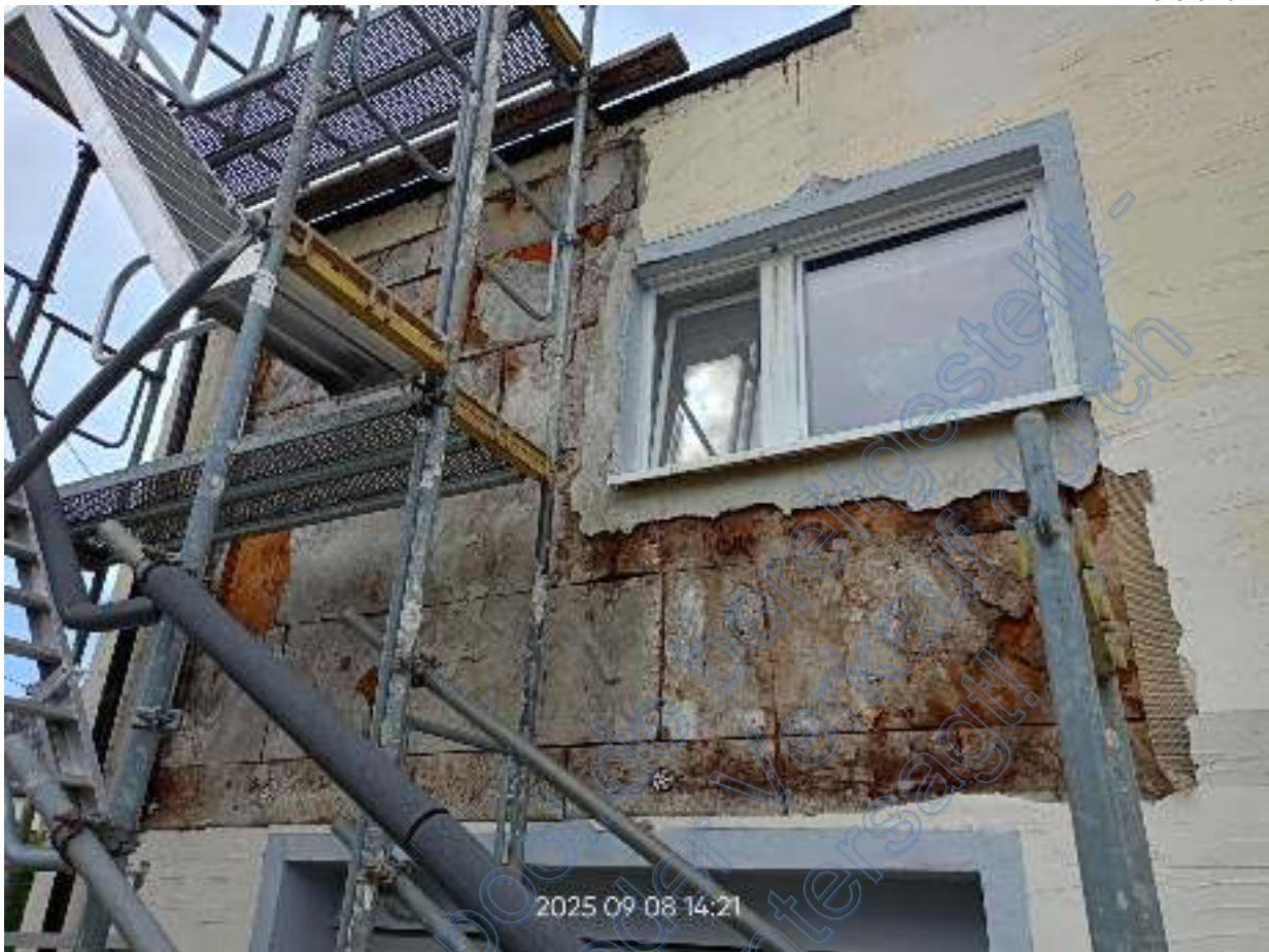
Schadhafte Außendämmung, exemplarisch für weite Teile der Fassade mit temporärer Erschließung der Einliegerwohnung im DG. Dadurch Garage aktuell nicht nutzbar.
