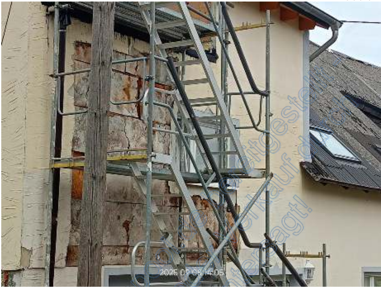
Temporäre Erschließung der DG-Wohnung mit schadhafter Fassade.
