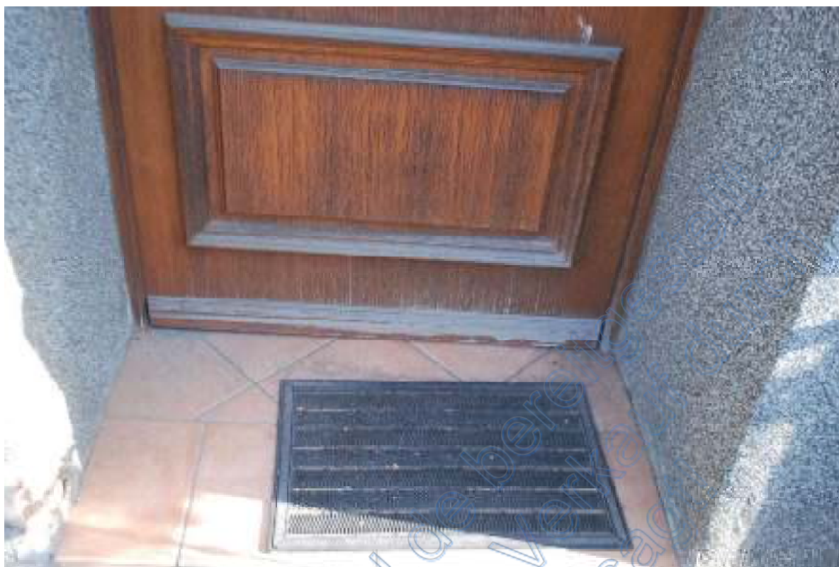
Hauseingangstür stark abgenutzt
