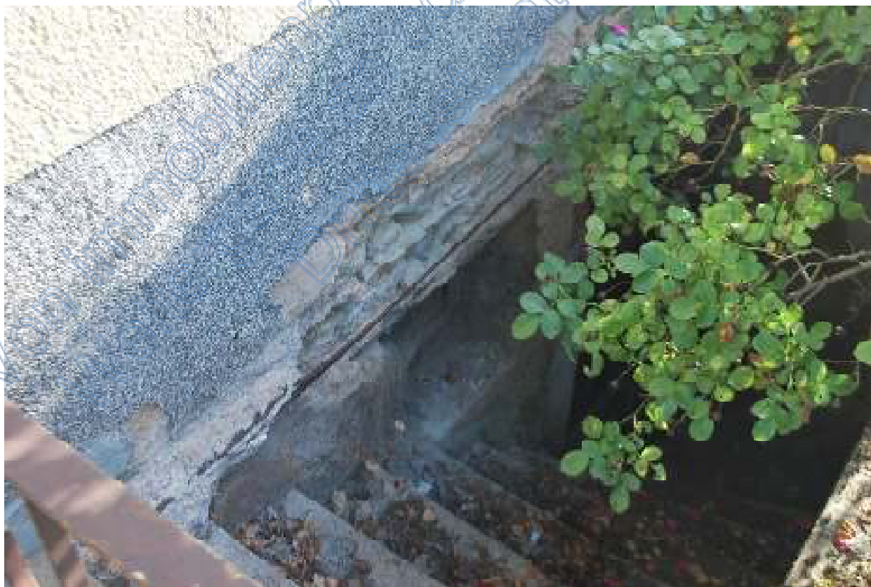
Kelleraußentreppe und Sockelputz abgängig
