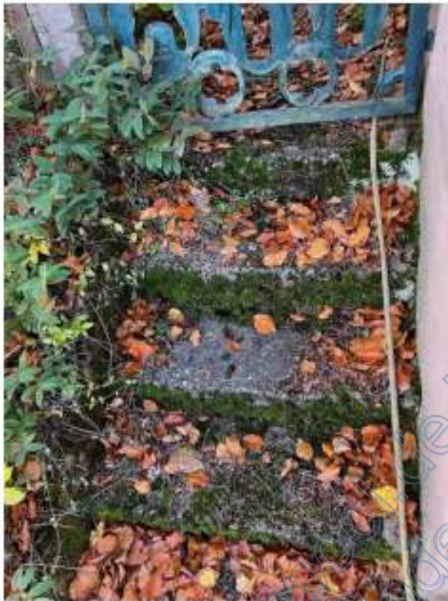
Zustand Außenanlagen (Treppe zum Eingang)
