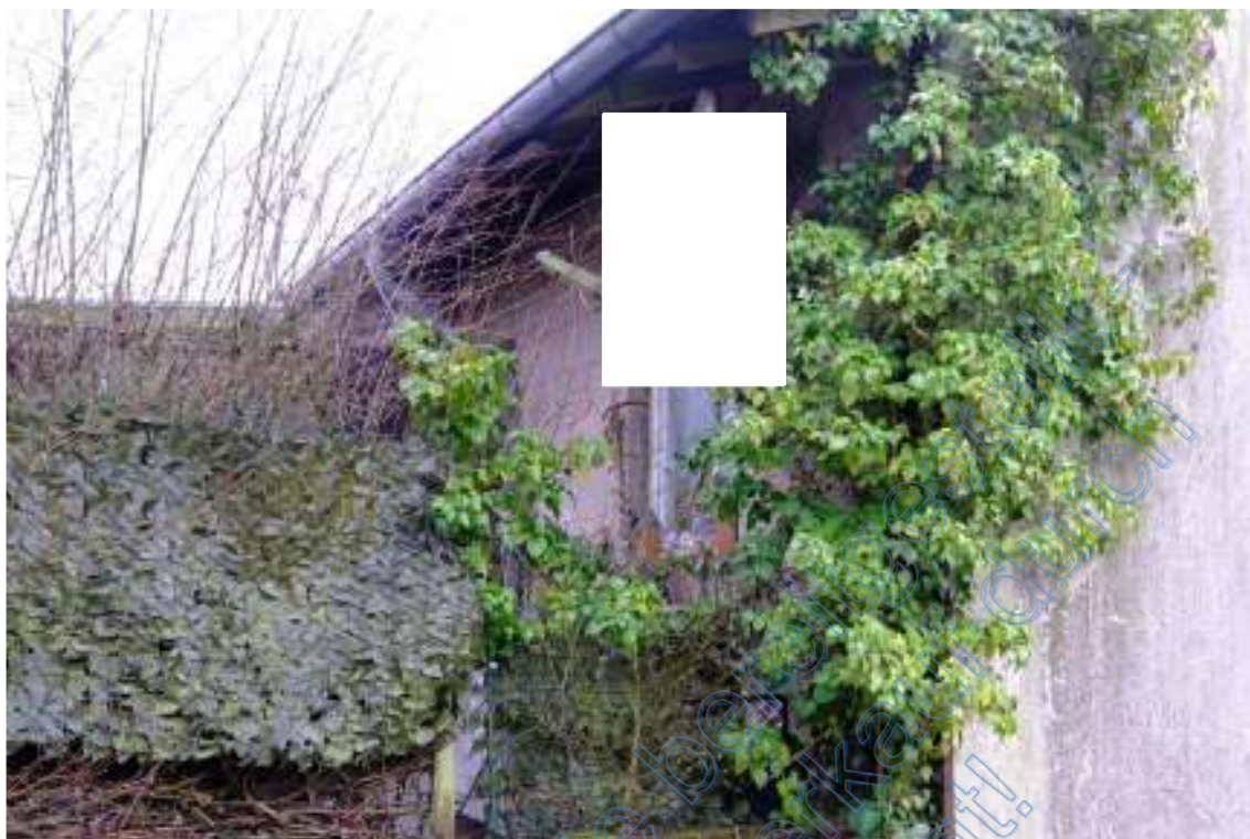
Rückseitiger Anbau Außenwandflächen ohne Außenputz
