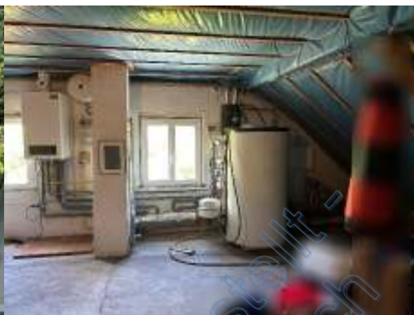
Heizung im Dachgeschoss
