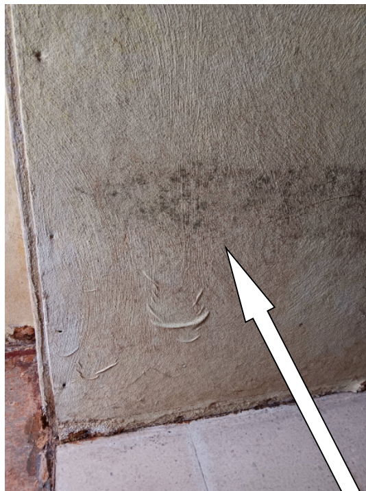
Wand links im Eingangsbereich des Flurs , Schimmel
