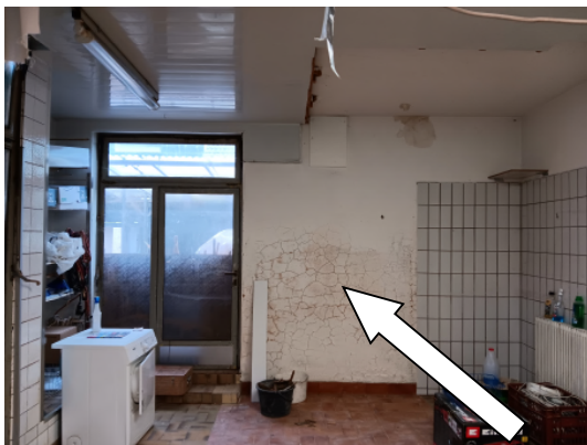
Ehemalige Backstube mit Schimmel
