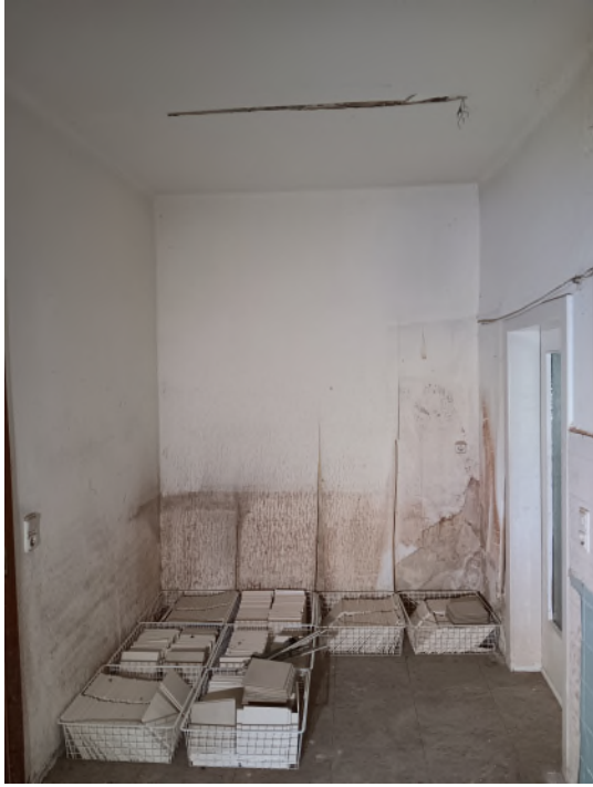
Küche , letztes sichtbares Hochwasser vom 14.07.2021
