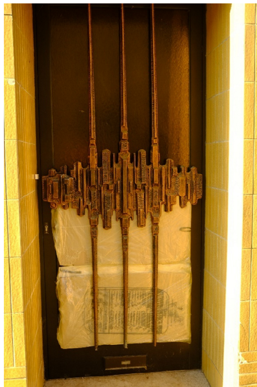
Haustür Glas schadhaft
