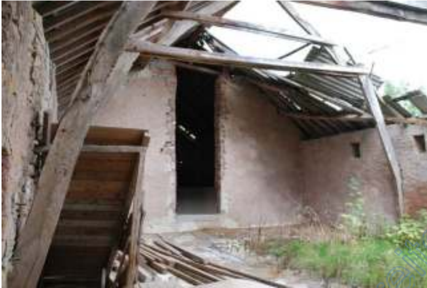
Detail Dach, zusammengestürzt
