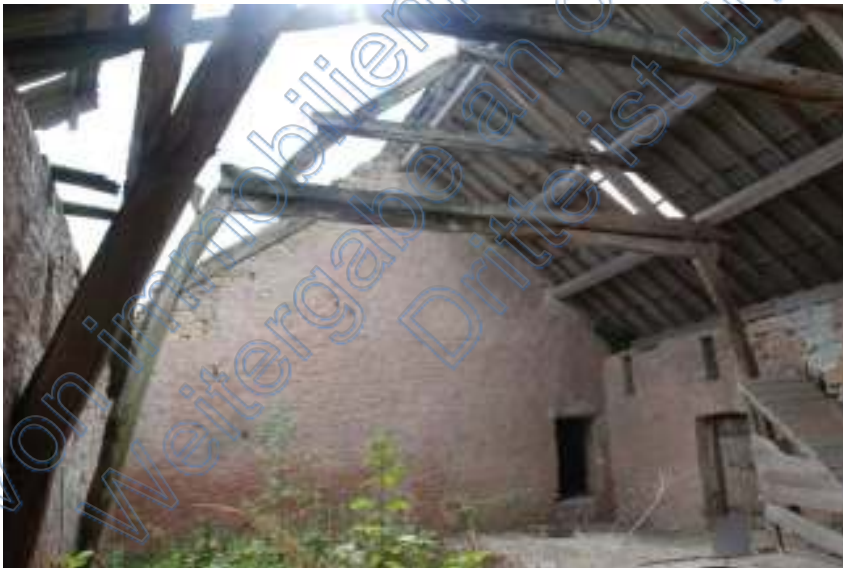
Detail Dach, zusammengestürzt
