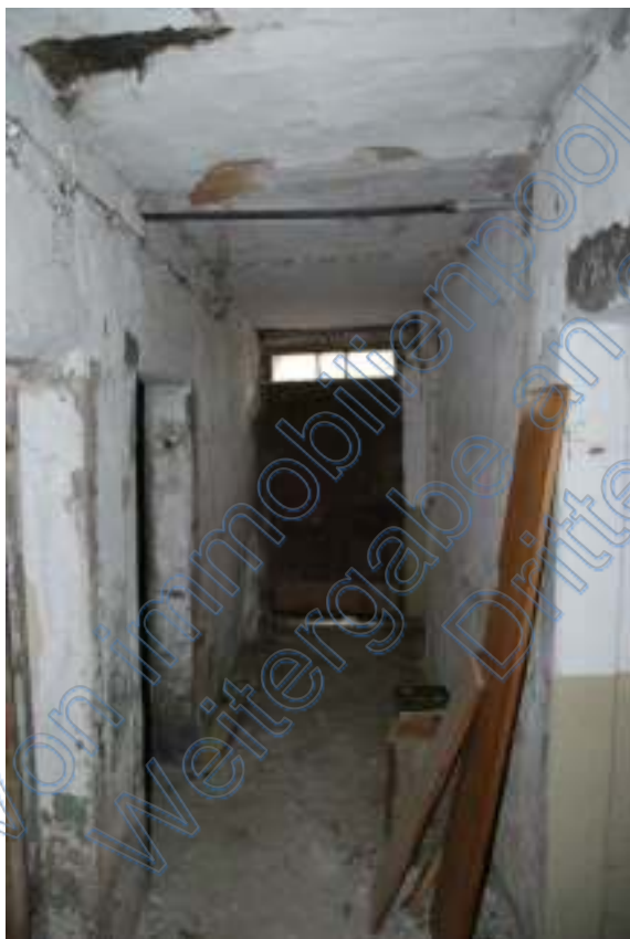
Innenansicht Flur, Innenansicht Hauseingang, Putzschäden
