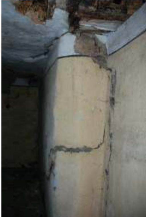
Detail Risses Schäden
