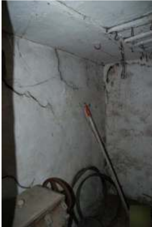
Innenansicht Kammer, massive Risseschäden
