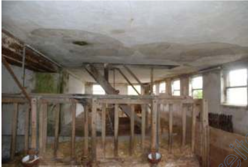
Innenansicht Stall, Decke Putz-/Feuchtigkeitsschäden
