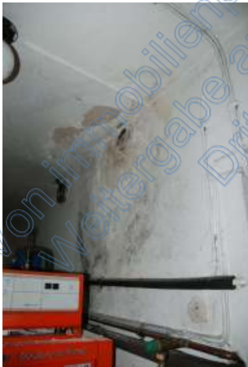
Detail Putz-/Feuchtigkeitsschäden, Wasserschaden
