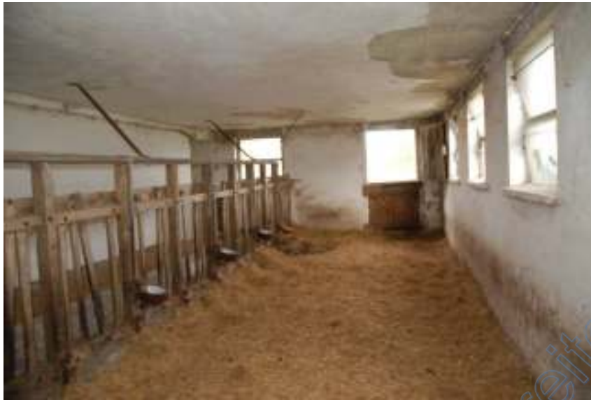
Innenansicht Stall, Putz-/Feuchtigkeitsschäden
