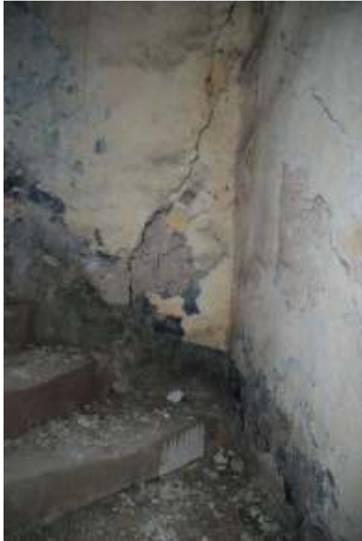
Detail massive Risses Schäden im Treppenhaus
