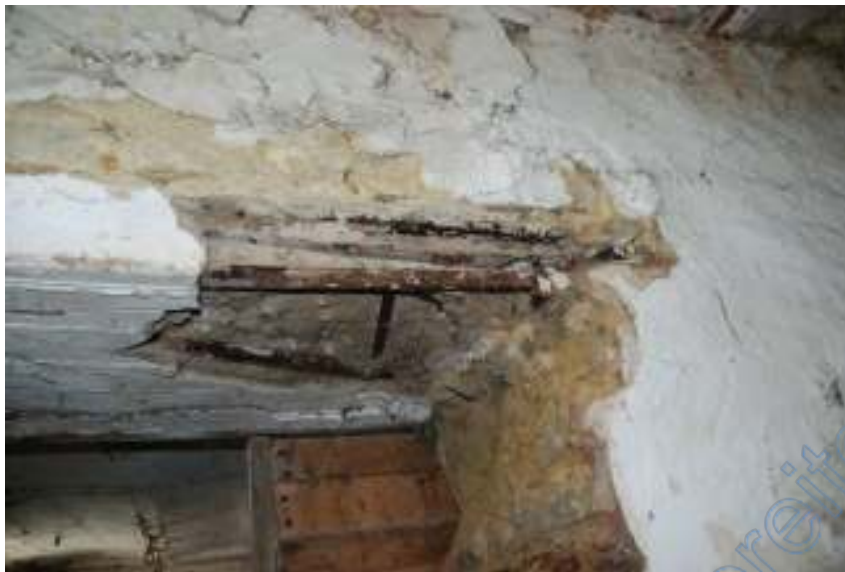
Detail Tüersturz, Betonabplatzungen
