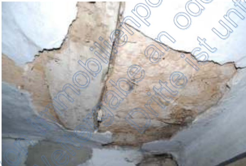
Detail Decke, Putz-/Feuchtigkeitsschäden
