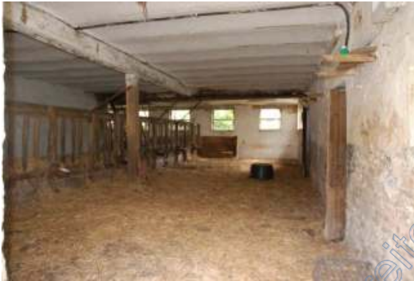
Innenansicht Stall, Putzschäden
