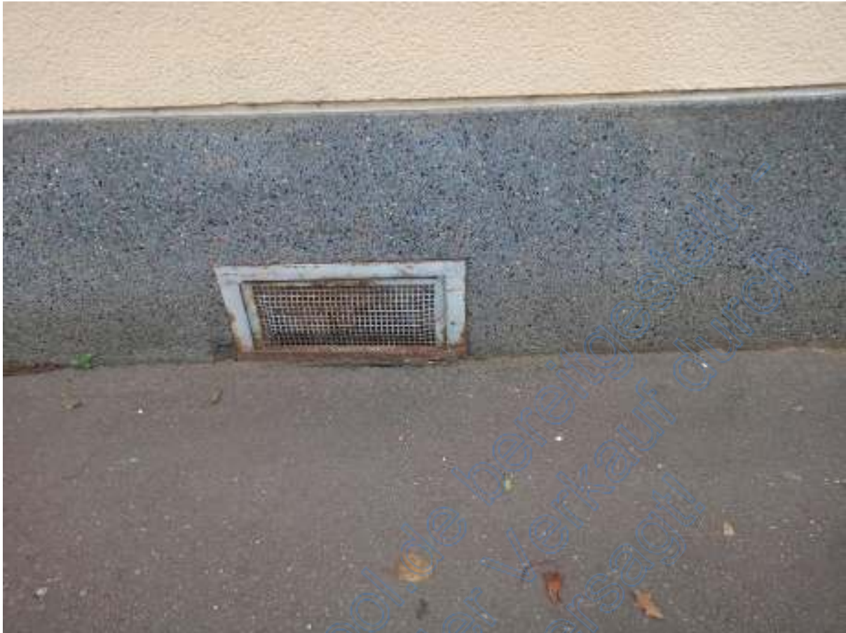
Abbildung 27 - Kellerfenster mit Bewitterungsspuren
