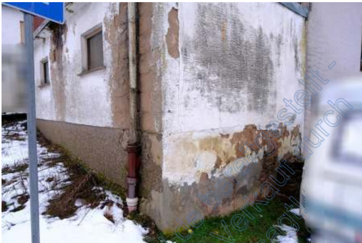
Aussenputz Garage schadhaft
