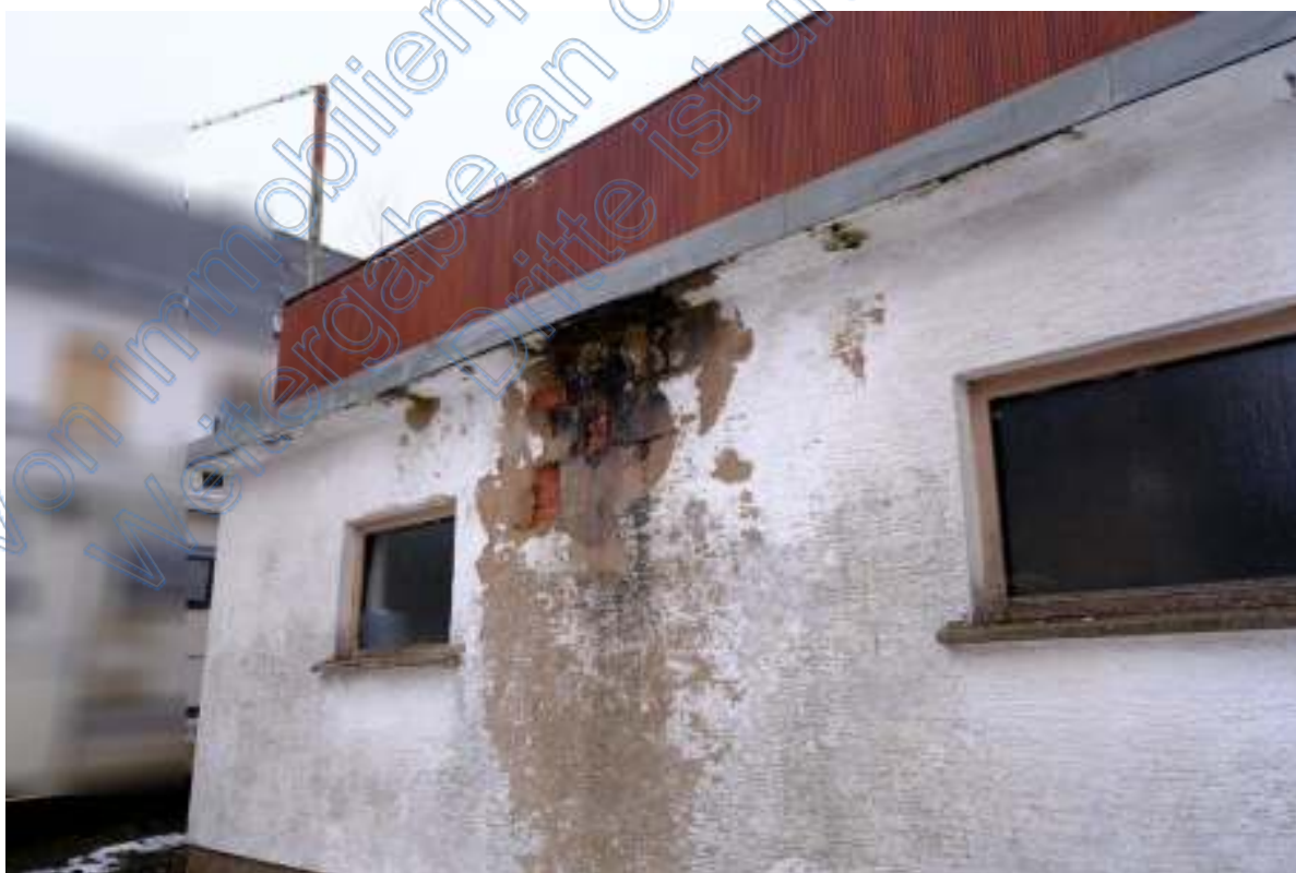
Dachabdichtung Garage schadhaft
