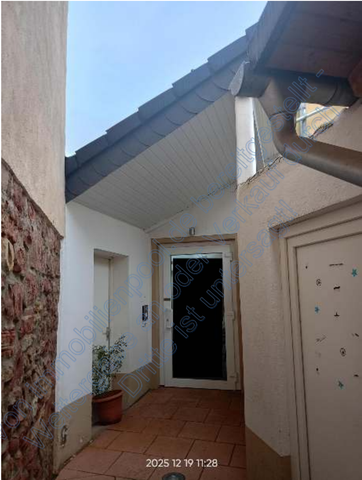
Überbau auf dem Bewertungsgrundstück durch das Nachbargrundstück mit Zuwegung.
