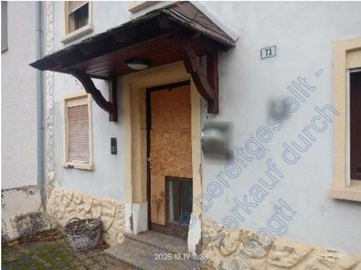
Hauptzugang des Bewertungsobjekts mit Vordach und beschädigter Haustüre.
