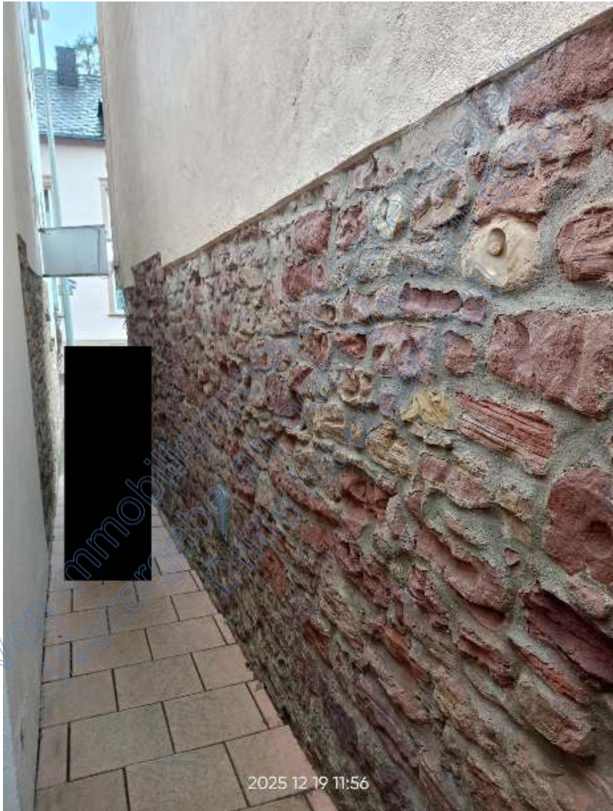
Giebelseite des Bewertungsobjekts im Bereich des nachbarlichen Wegerechts mit der Witterung ausgesetztem Mauerwerk.
