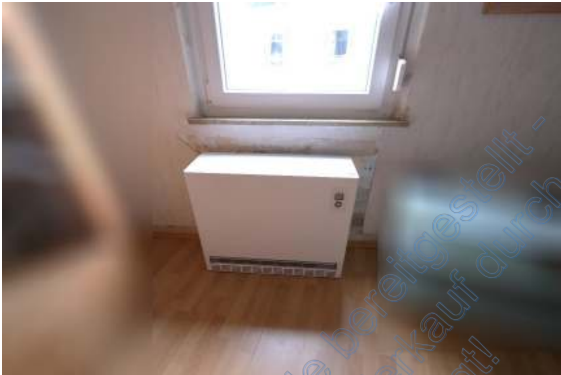
Elektronachtspeicherheizung, fehlende Wandbeläge
