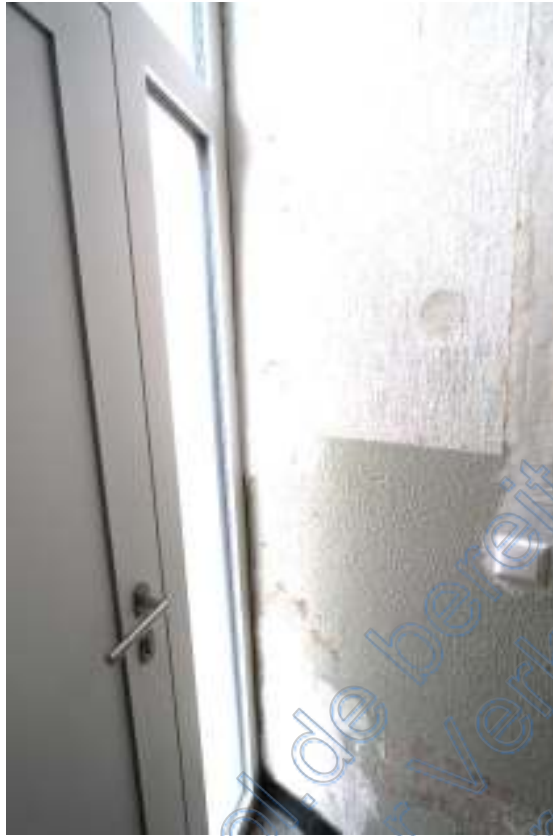
Fehlende Fertigstellung Wandbelag
