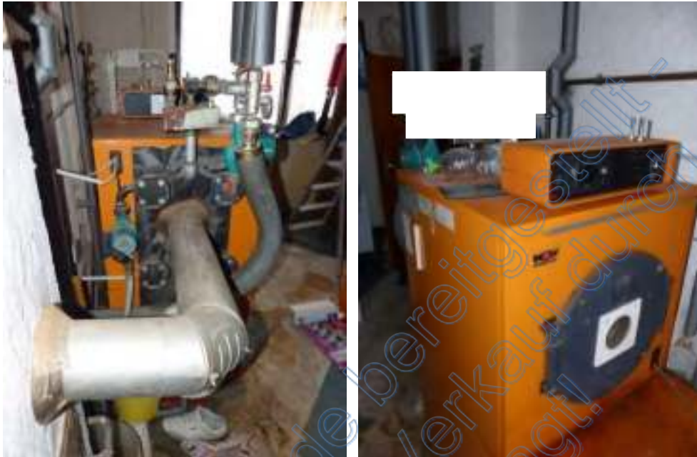
Heizungsanlage (fehlender Brenner u.a.) defekt und überaltert
