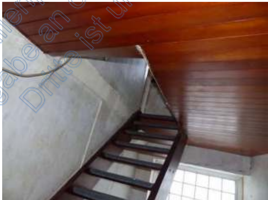
Treppenloch /Aufgang ohne Kopfhöhe
