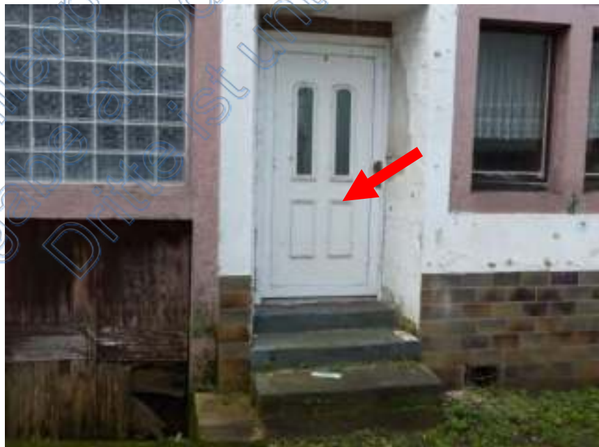
Hauseingangstüre (defekt) mit nebenliegendem Kellerabgang (nicht zu begehen)
