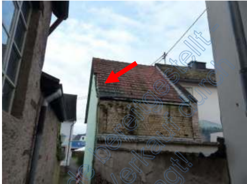
Rückansicht ehemalige Scheune (Dachgebälk faul / Dacheindeckung undicht)
