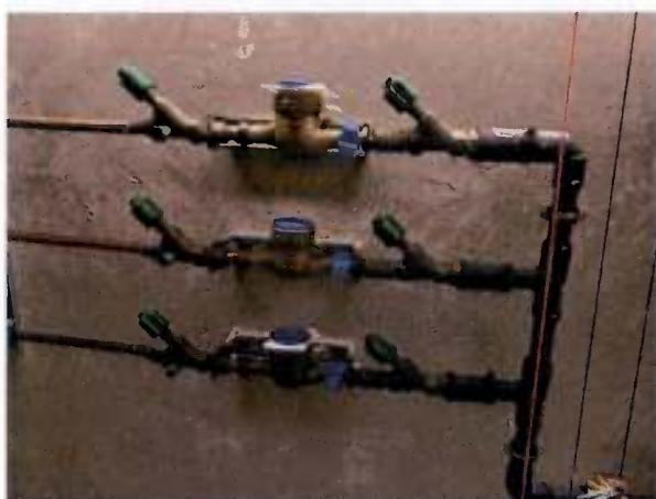
Wasseranschluss, getrennte Zählung
