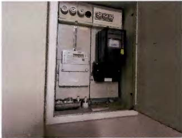
Stromzählerplatz im Flur
