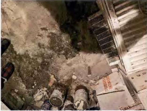
Mängel am Heizraumboden
