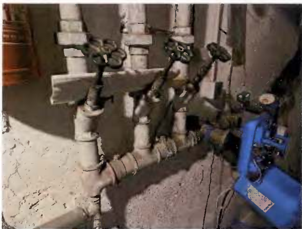
Wasseranschluss mit Verteilung
