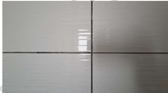
46 fehlende Fugenausbildung Bad (OG)
