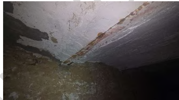
40 korrodierte Stahlträger Kellerdecke
