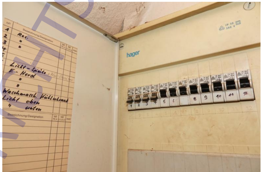
BILD 14 INNENANSICHT DACHGESCHOSS - ELEKTRO VERTEILERKASTEN -
