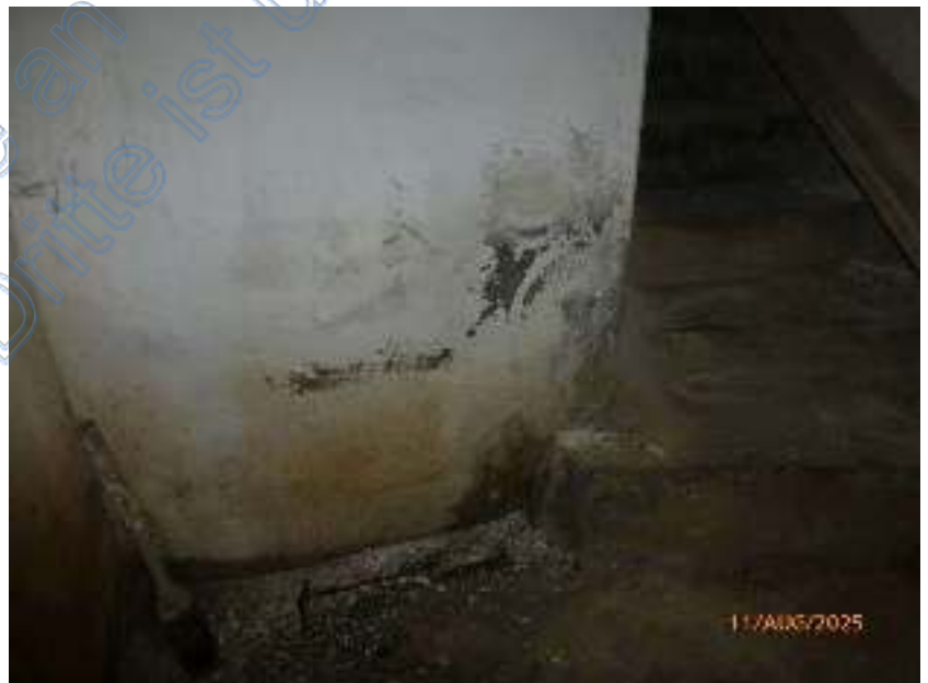
Innenansicht Keller mit Wandfeuchte
