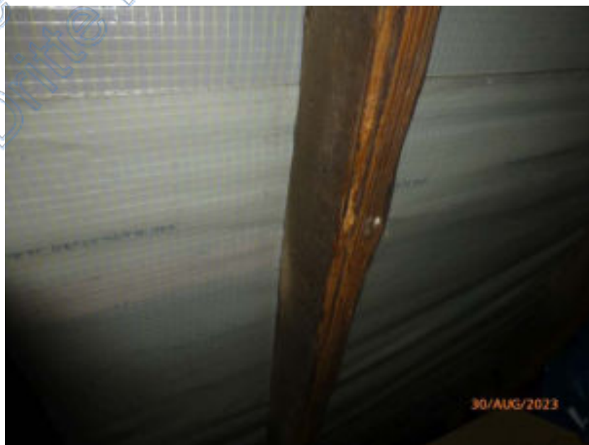
Innenansicht Spuren von Holzschädlingen
