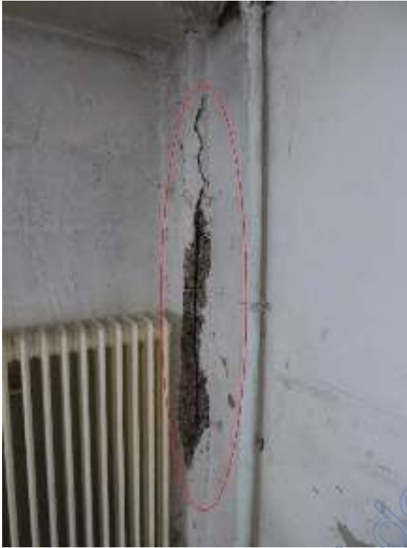
Bild 34: freiliegende, korrodierte Bewehrung eines Stahlbetonpfostens in der Waschk.
