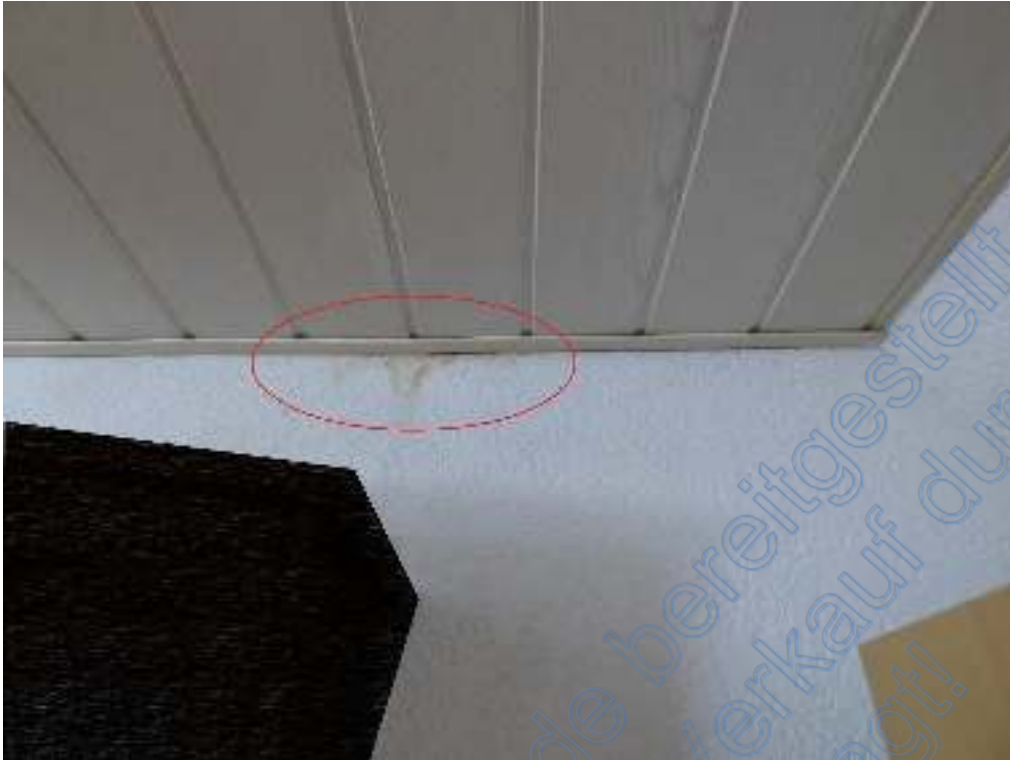
Bild 51: Feuchtigkeitschaden im Bereich des Wohnzimmer im Wohnbereich
