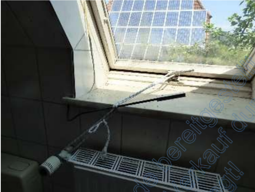
Bild 26: defektes Dachflächenfenster im Bad im DG
