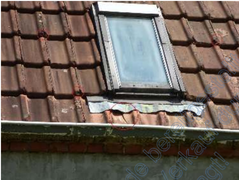
Bild 43: Mängel in der Dacheindeckung
