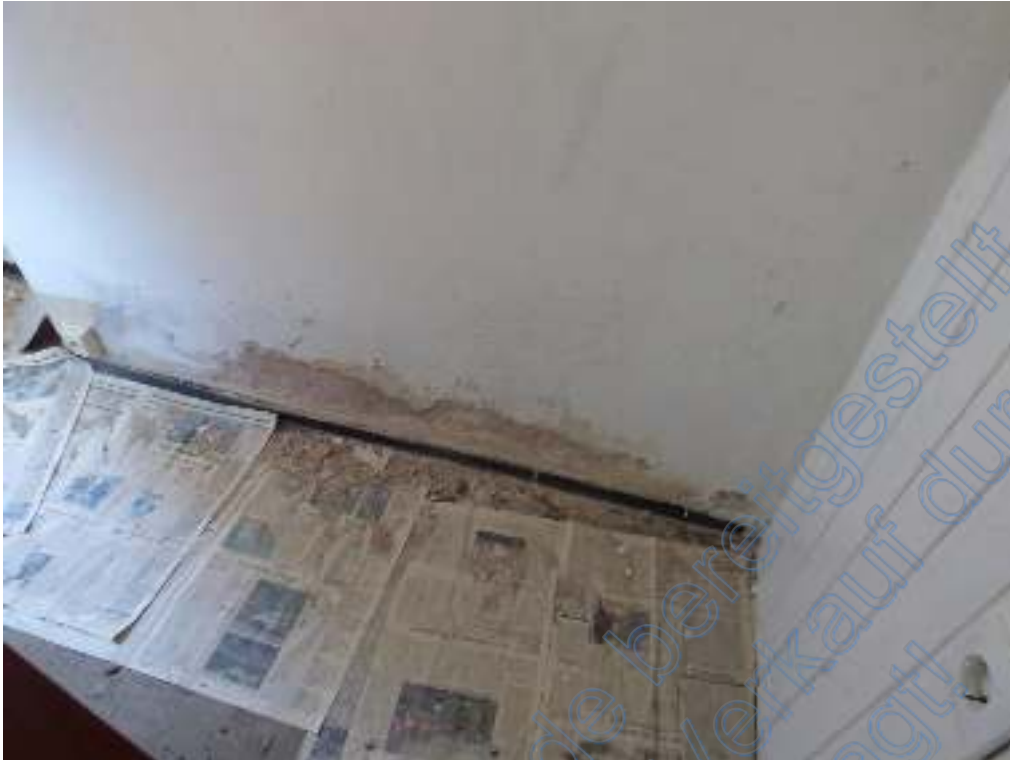
Bild 57: Feuchtigkeit in der Wand im Bereich des Kellerraums 2
