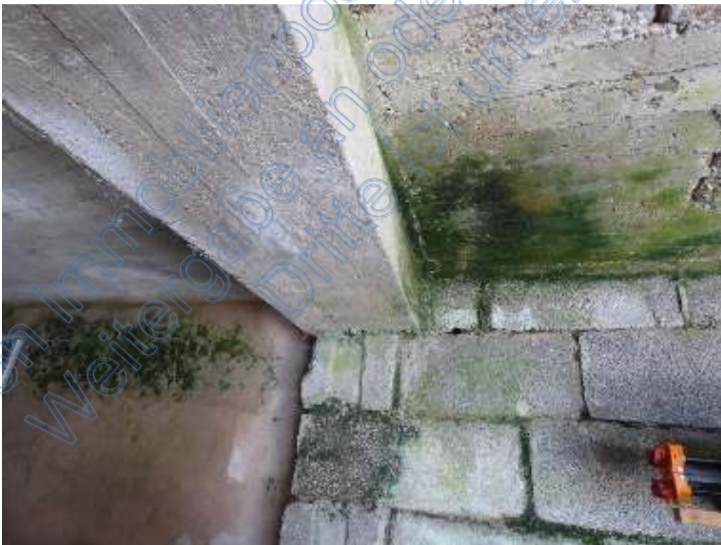
Bild 66: Feuchtigkeit im Lager (siehe Bilder 47 und 48)
