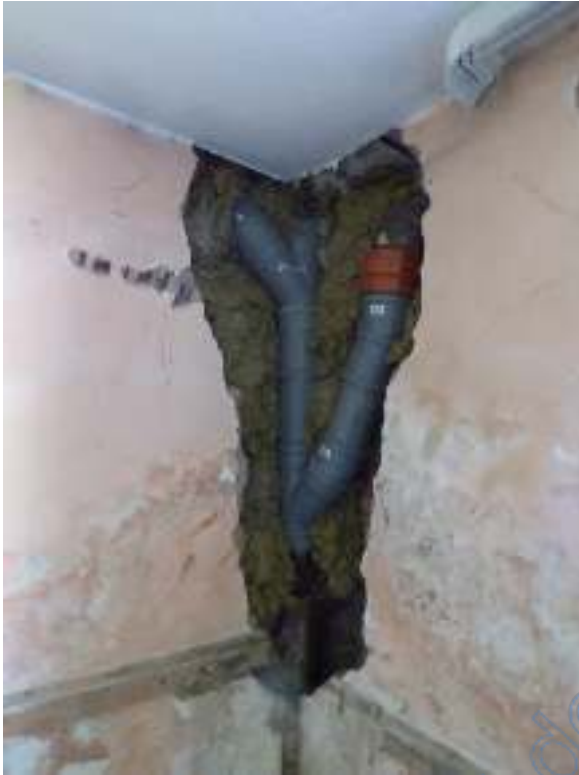
Bild 59: Entwässerungsleitung im Kellerraum 3 vom darüber liegenden Bad
