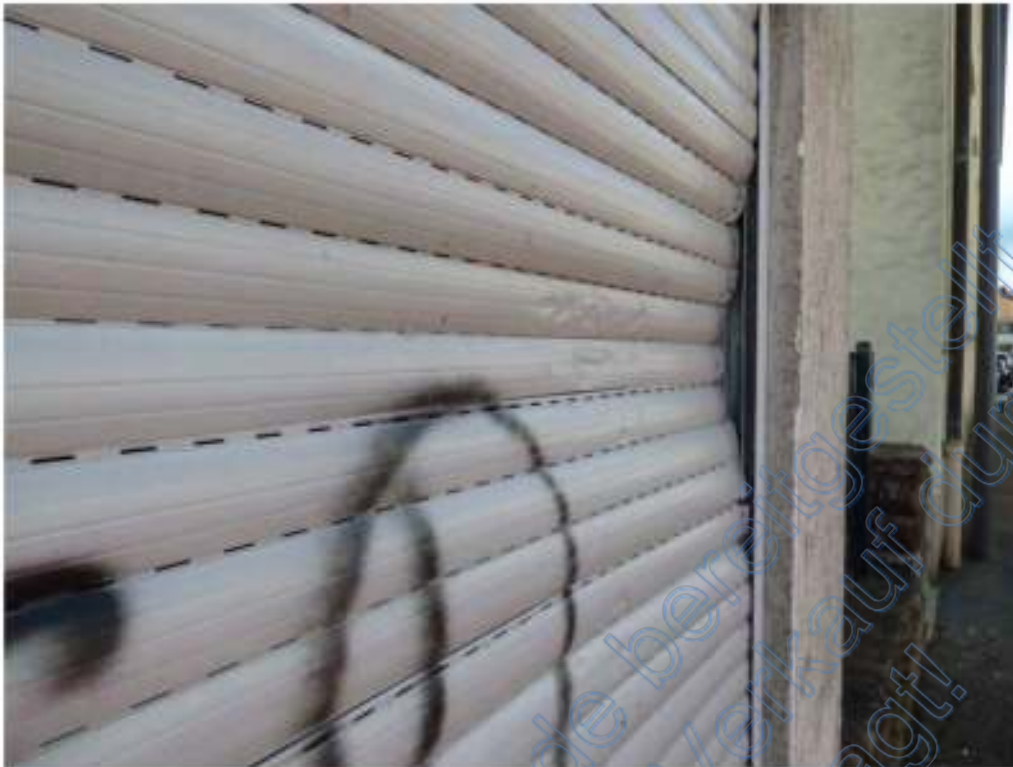
Bild 35: Beschädigter Kunststoffrollladen der Garage
