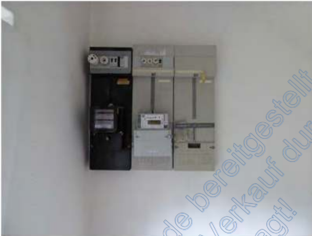
Bild 11: Stromzählerkasten mit Vorsicherung zu den Wohnungen im 1. und 2. OG
