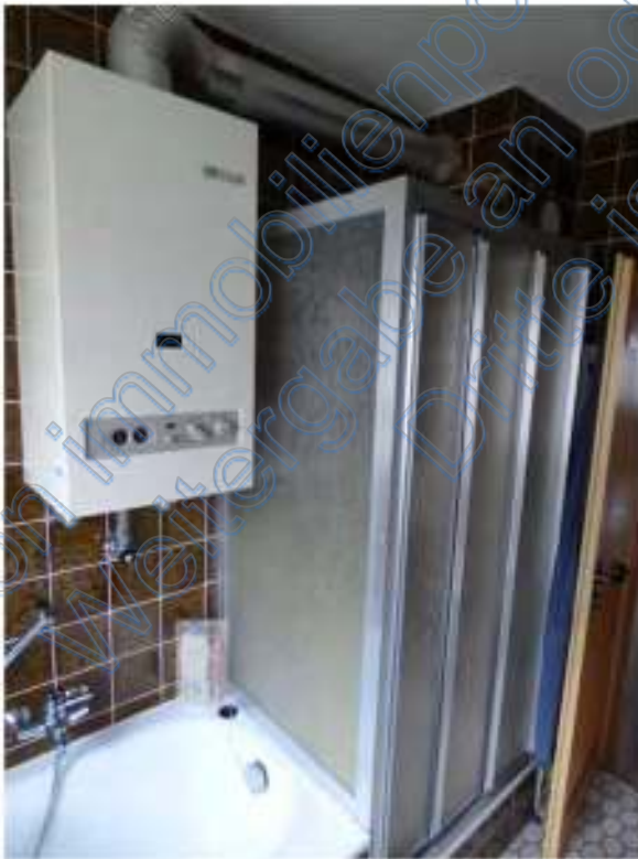
Bild 16: Gasetagenheizung sowie Dusche im Bad im 2.OG
