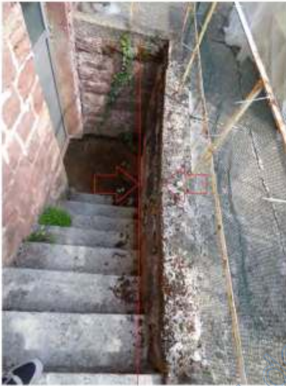
Bild 29: Zugang zum ehemaligen Tankraum über Außenber.; wölbende Stützwand
