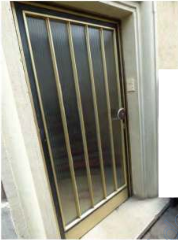
Bild 31: Hausabschlußtür im Bereich des Flurs vom Bild zuvor
