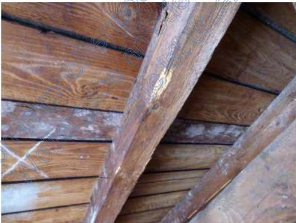
Bild 8: vereinzelt Holzwurm in der Dachkonstruktion
