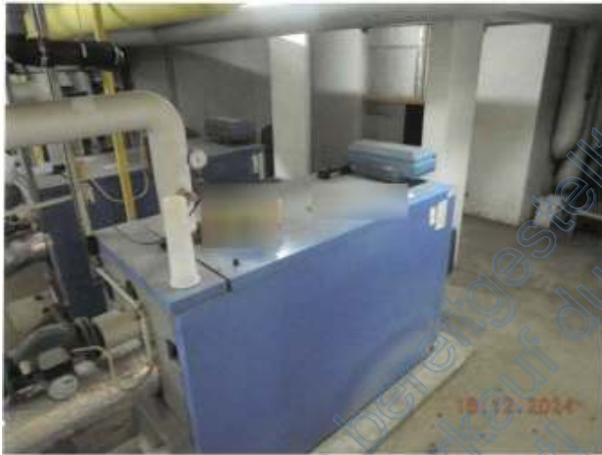
Bild 9: Heiztechnik im Kellergeschoss
