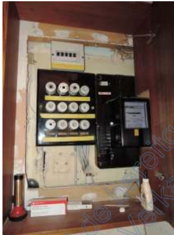
Abb. 23: Sicherungen in einem kleinen Nebengebäude (Schuppen) entlang der Seegasse
