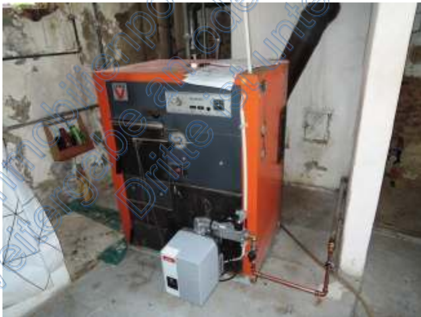
Abb. 22: Heizungstechnik in einem kleinen Nebengebäude (Schuppen) entlang der Seegasse
