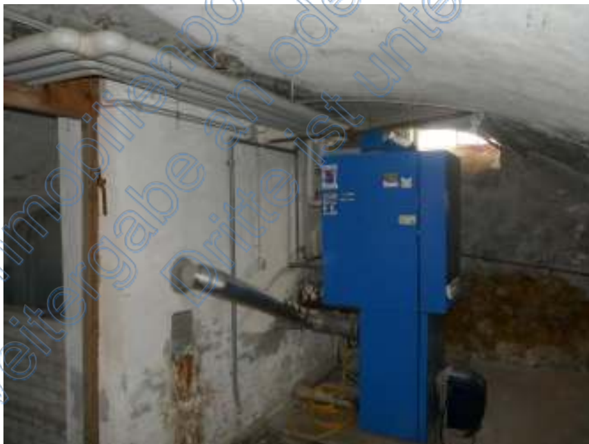
Abb. 14: Heizung im Kellergeschoss
