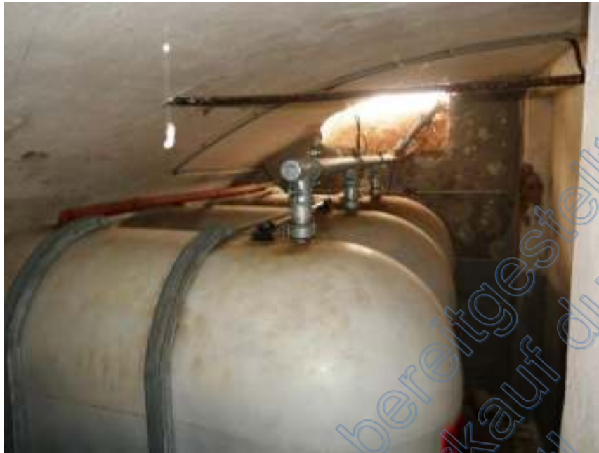
Abb. 15: Öltanks im Kellergeschoss
