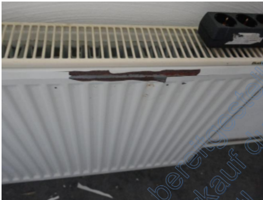
Abb. 35: "geplatzte" Heizkörper im Wohnhaus nach Frost-/Wasserschaden
