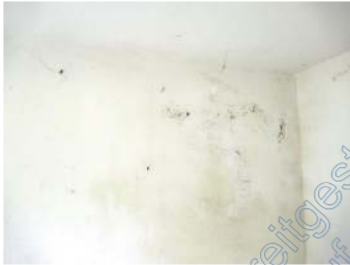
Abb. 33: Feuchtigkeitsschäden im Anbau des Wohnhauses (Erdgeschoss) nach Frost-/Wasserschaden
