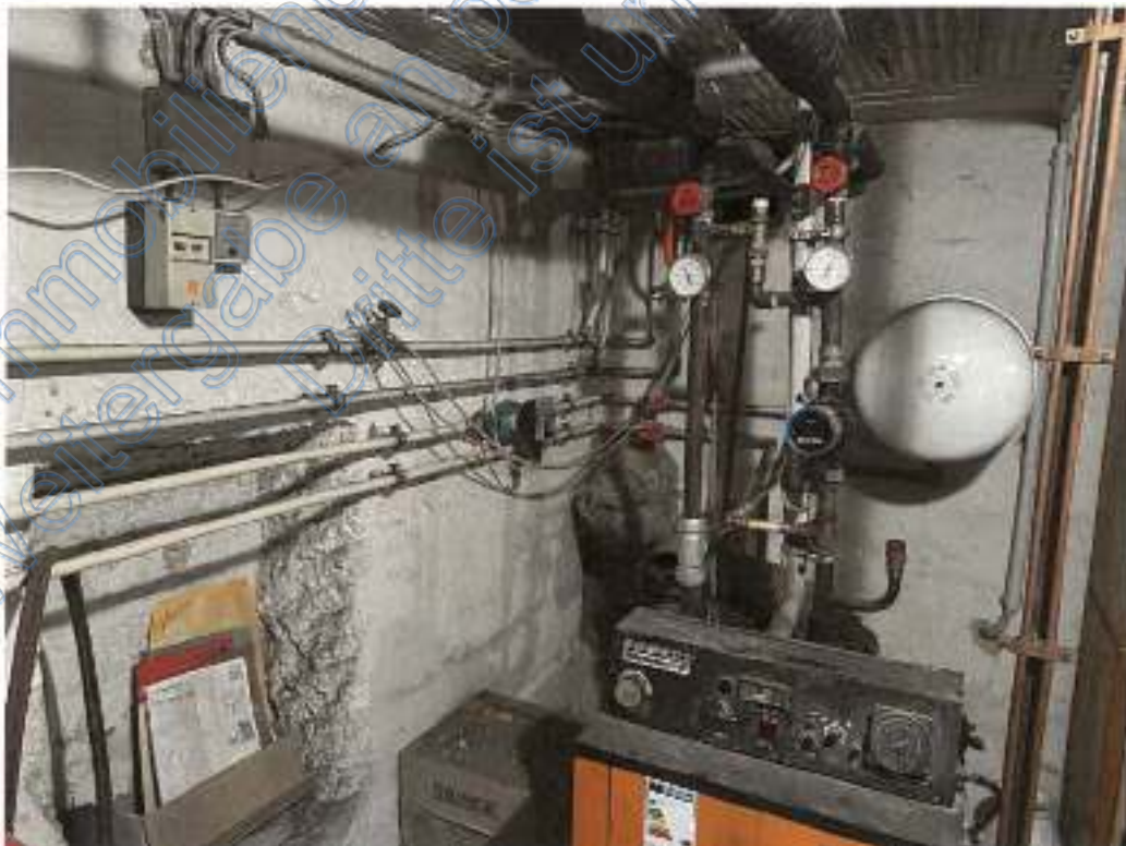
Technikraum im UG
