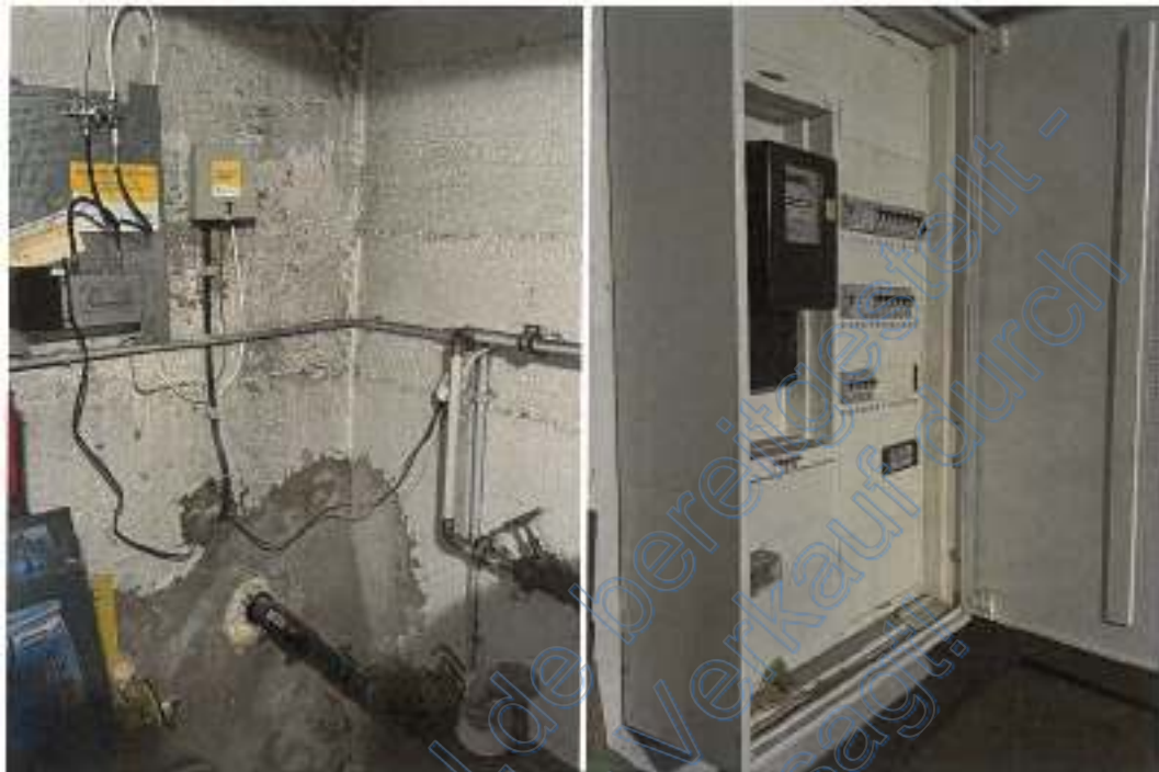
Technik, Hausanschlüsse – erneuerte Elektroverteilung
