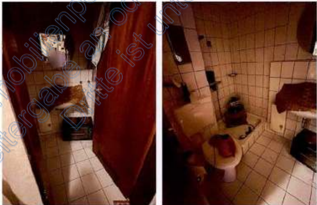
Bad / WC - Bereich im Sondereigentum
