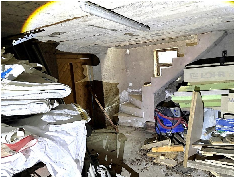
Bild 4: Blick auf die Treppe vom Keller zum Erdgeschoss mit Feuchtigkeitsschäden
