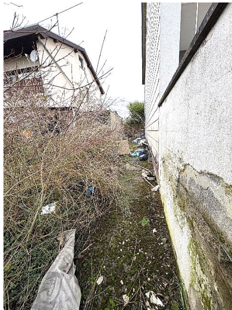
Bild 2: Feuchtigkeitsschäden im Bereich der Terrasseneinfassung/-brüstung (Westseite)
