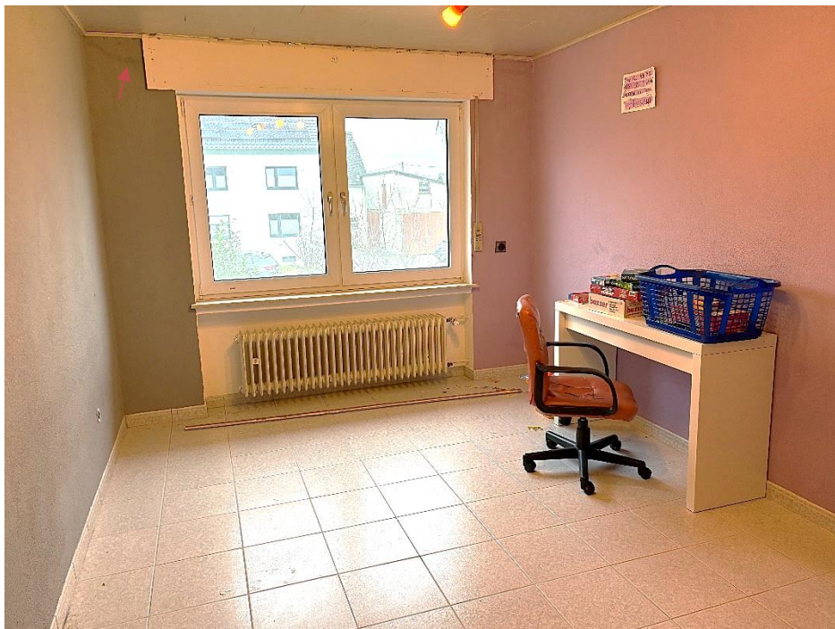
Bild 8: Zimmer im Obergeschoss mit leichten Feuchtigkeitsschäden im Außenwandbereich (Pfeil)
