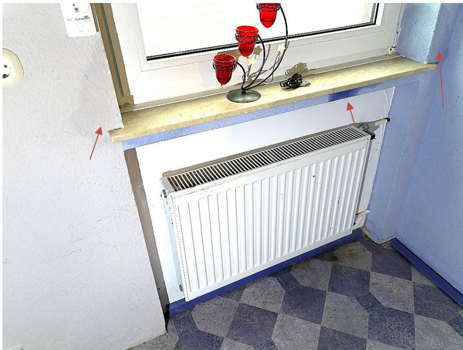
Bild 10: Flur im OG mit aktuell eindringender Feuchtigkeit im Bereich des Fensters (Pfeile)
