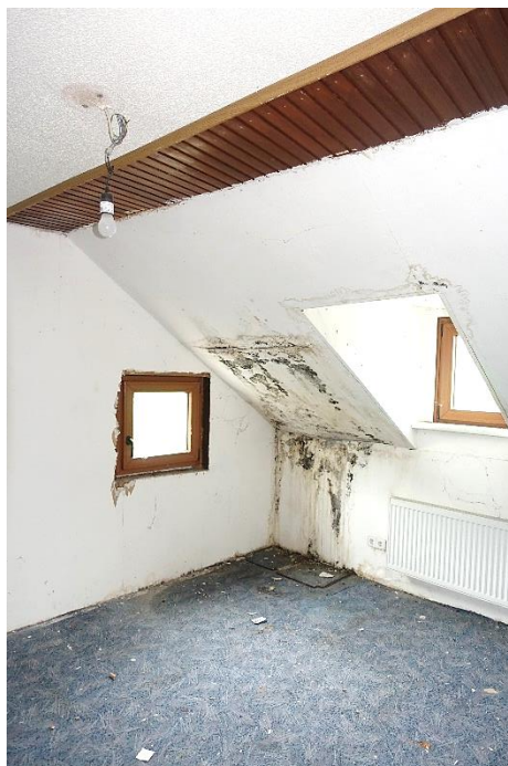
Bild 12 : Feuchtigkeitsschäden im Dachgeschoss (vermutlich vor Erneuerung der Dacheindeckung)
