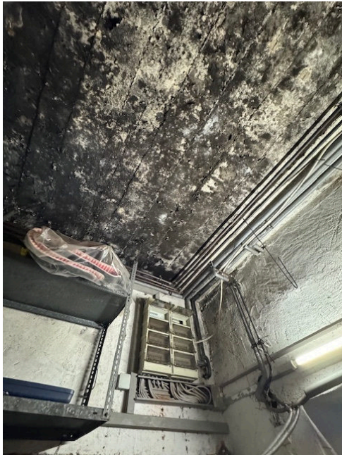
Bild 17: Feuchtigkeitsschäden im KG
