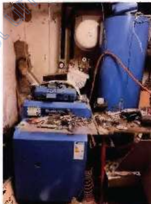
Bild 30: Heizung im KG
