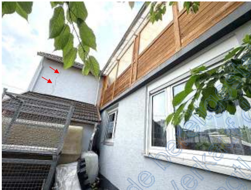
Bild 3: starke Rissbildungen im Mauerwerk des Lagergebäudes (Pfeile)
