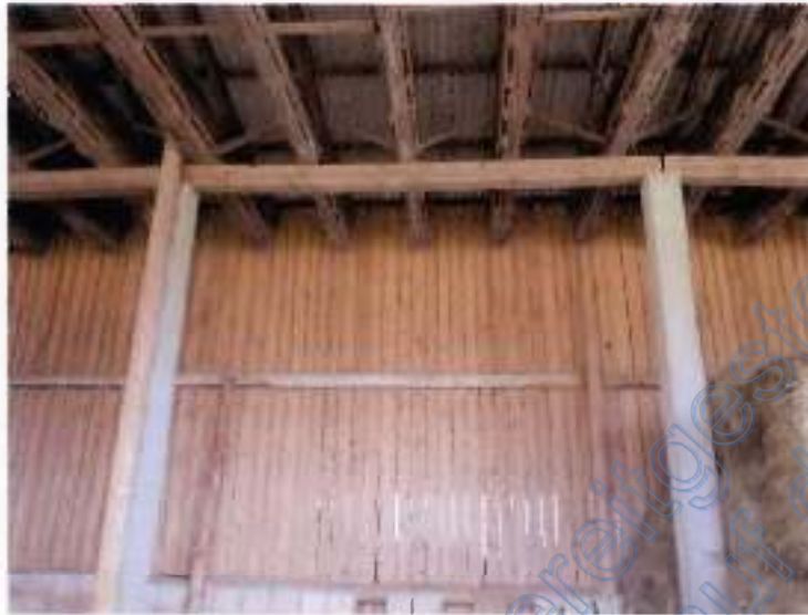
Foto 11 – Durchbiegung Koppelpfetten Mehrzweckhalle
