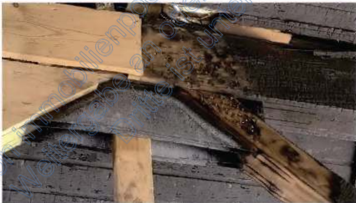
Bild D10 Beispiel Brandschaden
