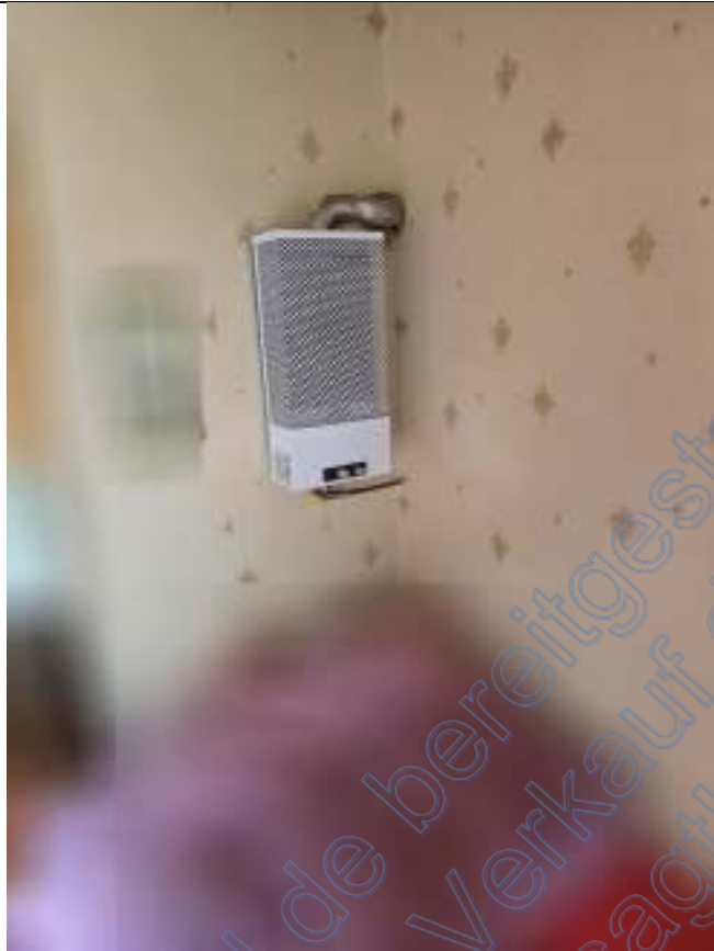
Bild 6: Die Gastherme ist nicht mehr in Betrieb
