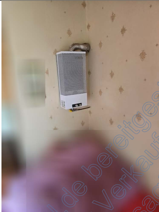
Bild 6: Die Gastherme ist nicht mehr in Betrieb
