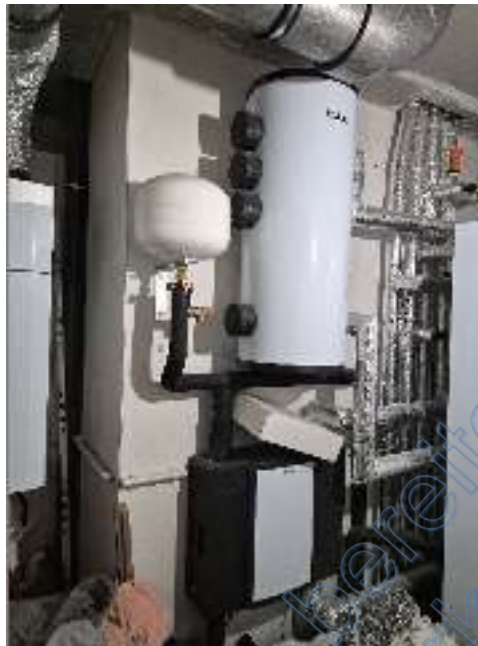
Bild 11: Innenansicht: des Bewertungsobjektes, Technikraum im EG
