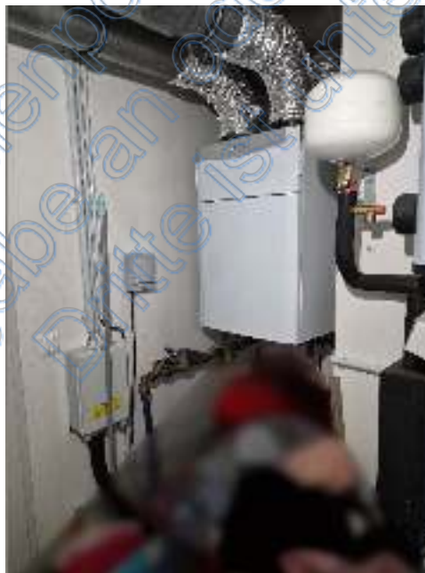
Bild 10: Innenansicht: des Bewertungsobjektes, Technikraum im EG
