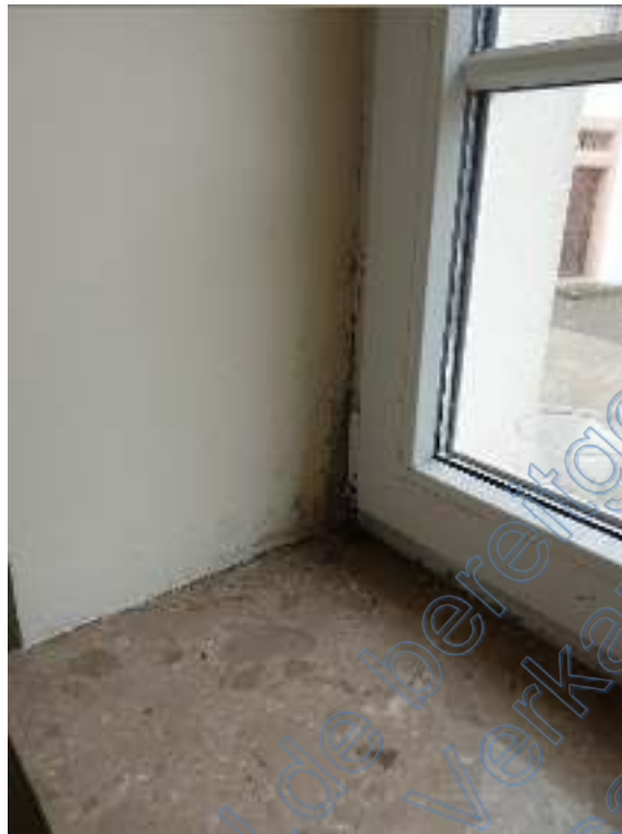
Bild 19: Innenansicht: des Bewertungobjektes, Feuchtigkeits-/Schimmelschäden im EG
