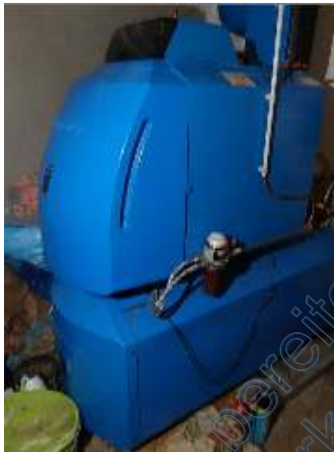
Bild 25: Innenansicht: des Bewertungsobjektes, Heizkessel
