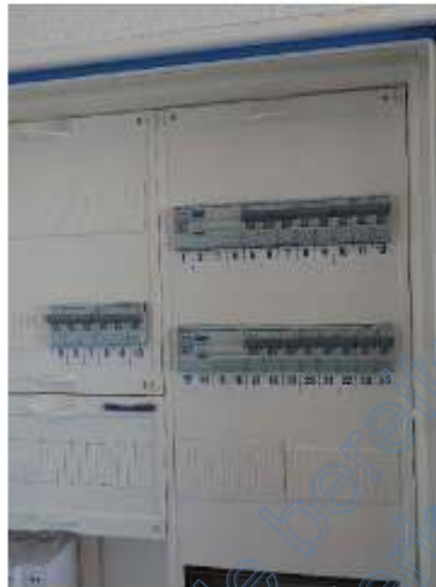
Bild 21: Innenansicht: des Bewertungsobjektes, hier Hauptgebäude, hier Elektro-Zahleschrank
