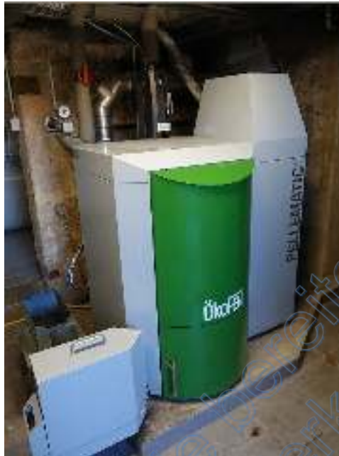
Bild 31: Innenansicht: des Bewertungsobjektes, hier Hauptgebäude, Heizkessel im KG
