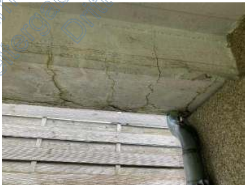
Bild 9 unterseitige Riise im Unterzug der linken Auflagerlinie
