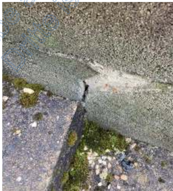
Bild 11 Vertikaler Riss in linker Garagenaußenwand neben Treppe
