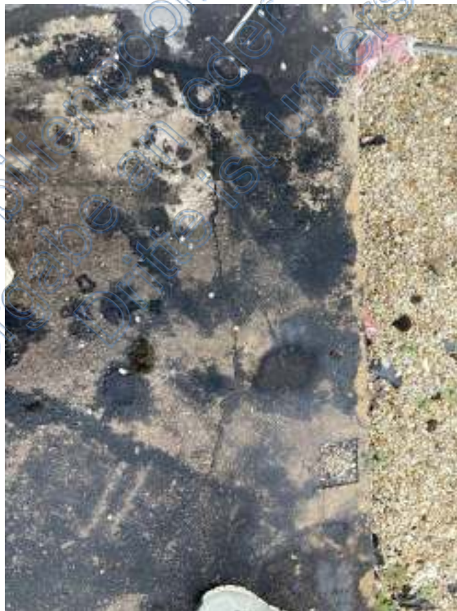
Bild 6 Oberseitige Harrisse rechtes Endauflager bei Stützwand
