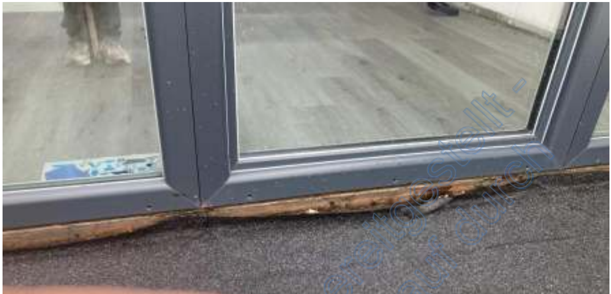
Bild 10 Wärmebrücke bei Terrassentür
