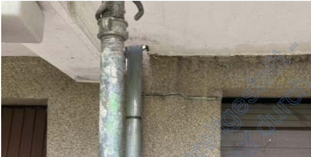
Bild 5 Horizontaler Riss neben dem rechten Garagentor
